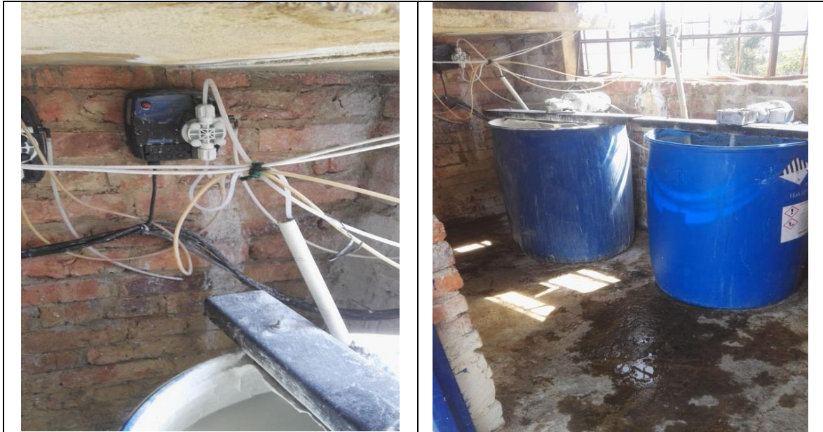
Imágenes 44 y 45 . Desinfección cloro gaseoso.
