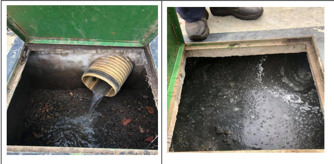
Imagen 62 y 63. Entrada del agua residual y caja de inspección entrada.
