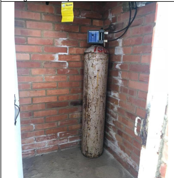
Imagen 22. Inyector dosificador de cloro.
