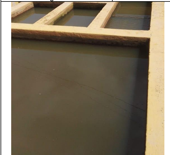
Imagen 42. Panel tubular, sedimentador.
