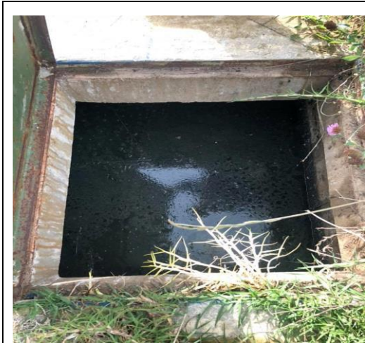
Imagen 70. Caja de inspección salida
