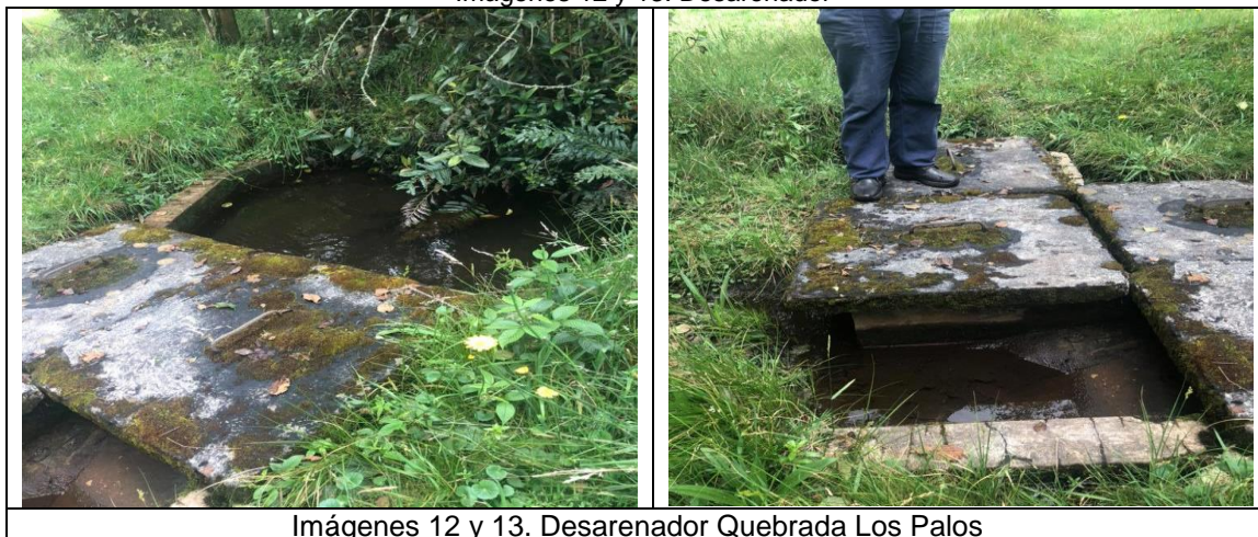
Imágenes 12 y 13. Desarenador
