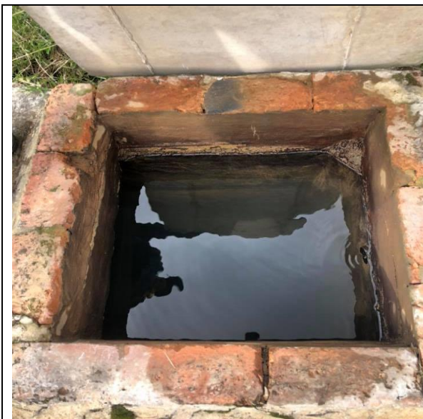
Imagen 20. Tanque de almacenamiento 80m3.
