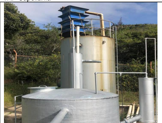
Imagen 35. Torre de aireación.
