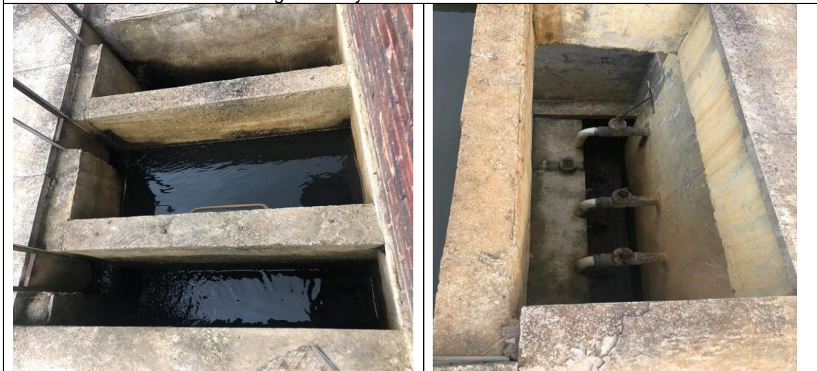
Imagen 20. Cuatro (4) Filtros compuestos por grava, arena y antracita.
