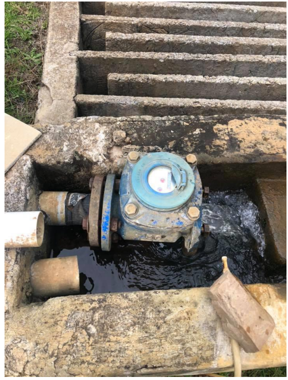
Imagen 15. Macromedición a la entrada de la PTAP
