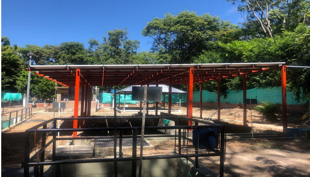
Fotografía 53 Sistema de Tratamiento de Aguas Residuales del municipio de Yaguará, Huila.
