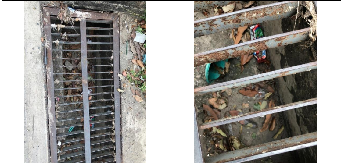
Fotografía 49 y 50 sumidero carrera 1 con calle 2
