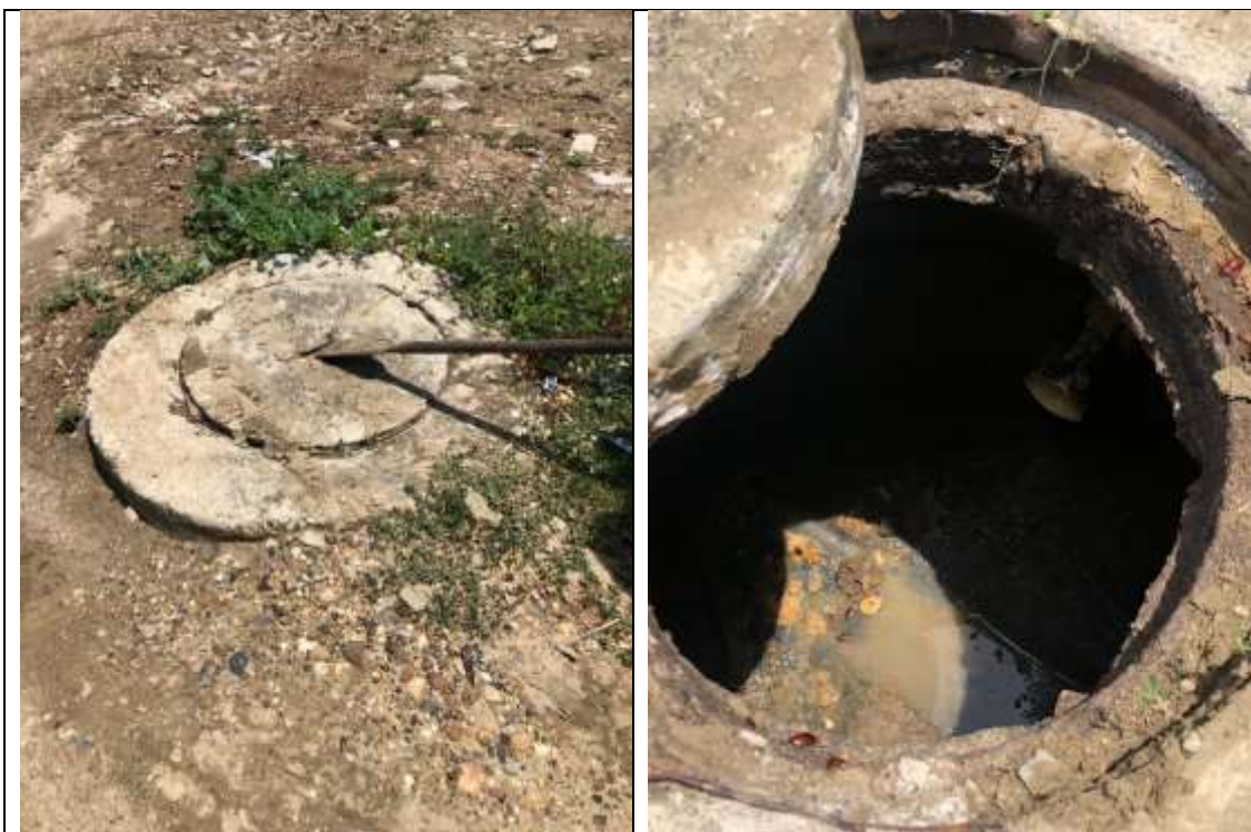
Pozo de Inspección en la Via albania.
