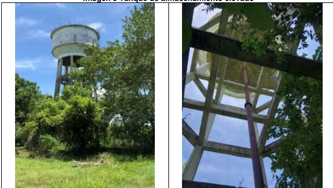
Imagen 9 Tanque de almacenamiento elevado
