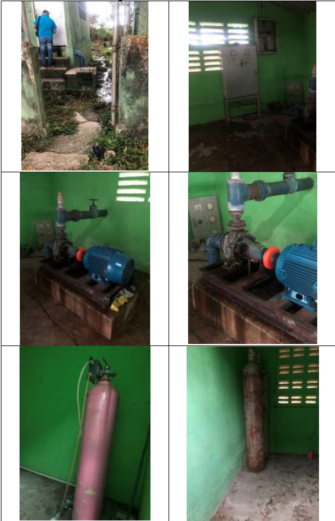
Imagen 8 Sistema de desinfección
