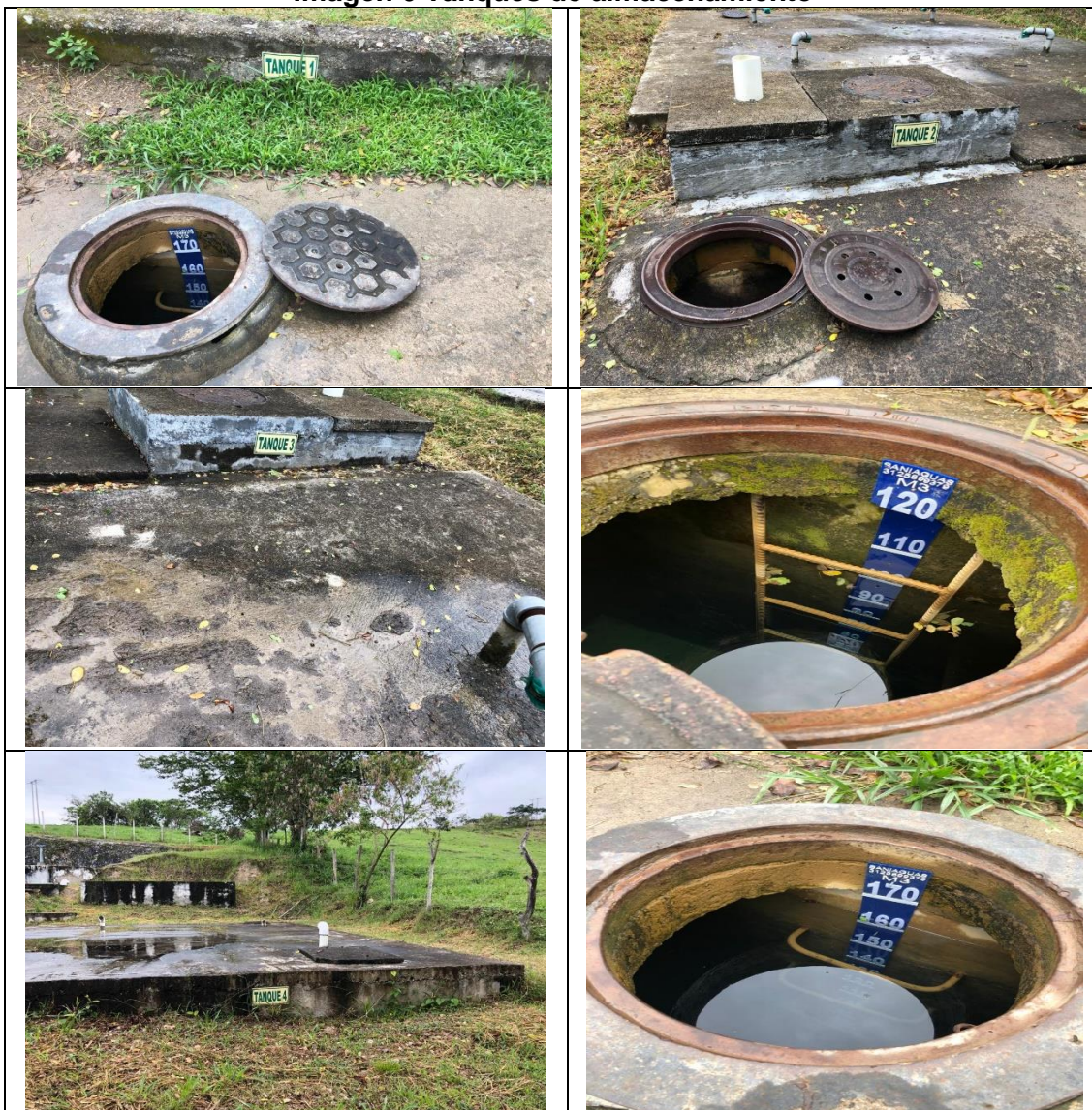
Imagen 6 Tanques de almacenamiento
