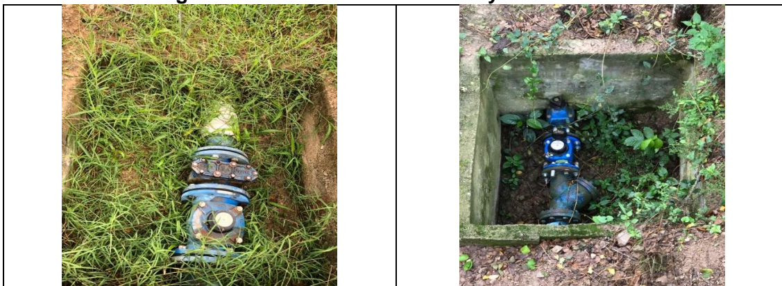
Imagen 7. Macromedidores entrada y salida de PTAP
