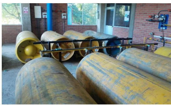
e) Tanques de cloro gaseoso
