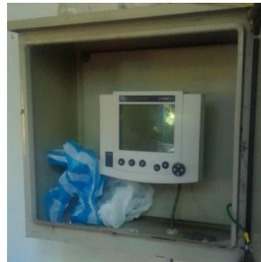
f. Aparato de reporte de información de calidad de agua no funcionando por fallas eléctricas
