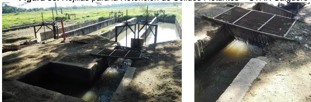
Figura 38. Rejillas para la Retención de Sólidos Flotantes – STAR Salguero
