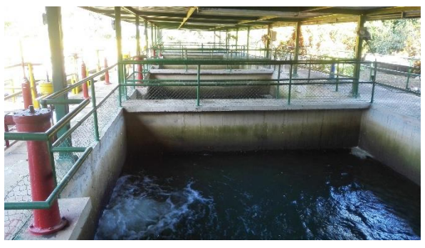
d) Tanques de filtración
