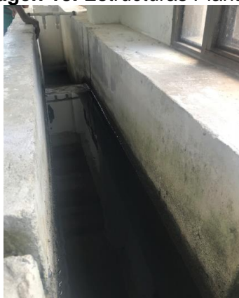
Canal de entrada a la PTAP
