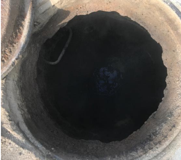
Manhole ubicado en la calle 8 carrera 9: flujo normal, tapa en buen estado.
