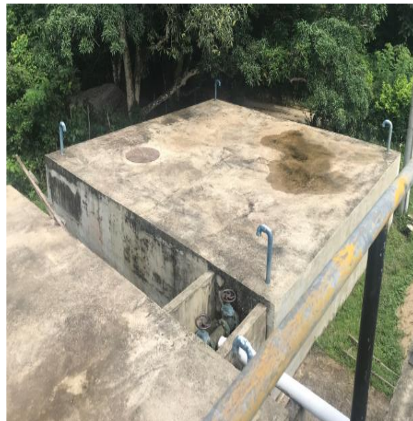
Imagen 22. Tanques de Almacenamiento PTAP Río Ancho.
