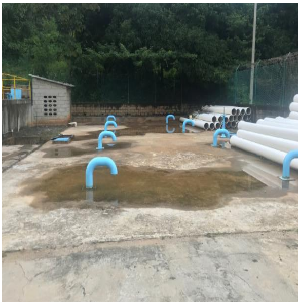
Imagen 21. Tanques de Almacenamiento PTAP Pozo azul
