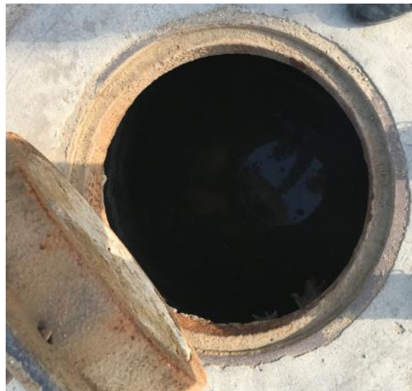
Pozo ubicado en la calle 6 con carrera 9: sin flujo, tapa en buen estado
