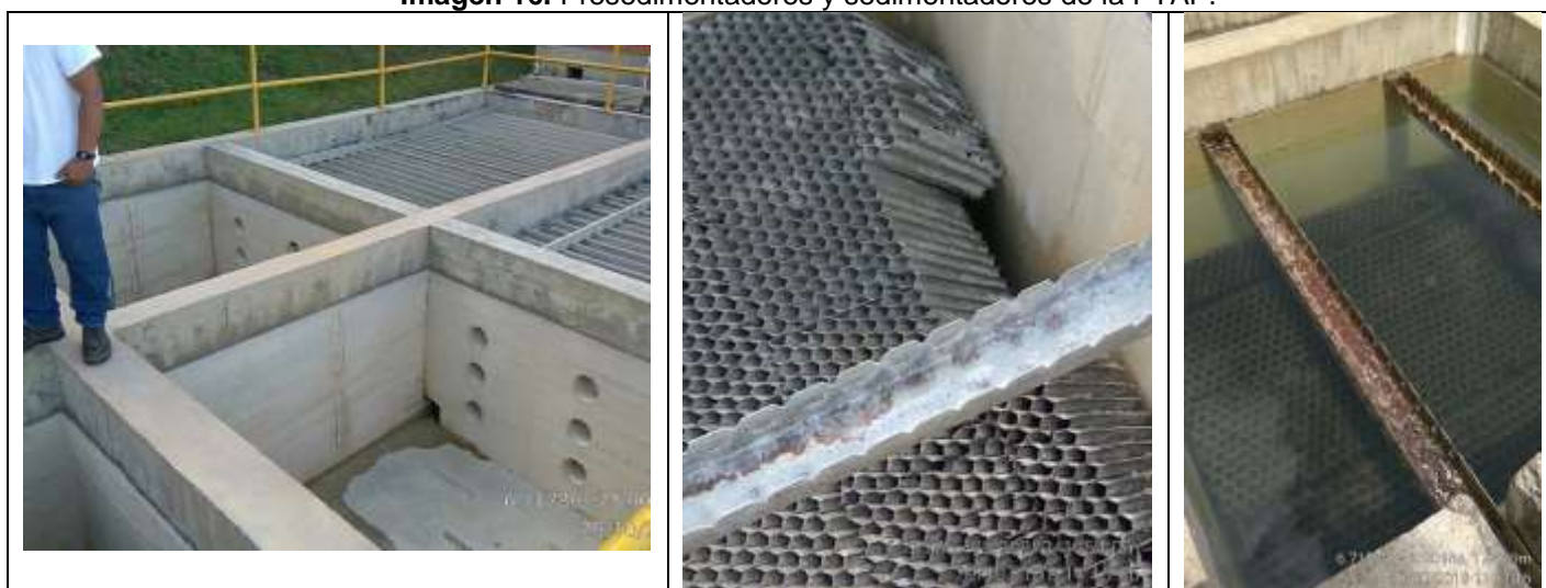
Imagen 16. Presedimentadores y sedimentadores de la PTAP.
