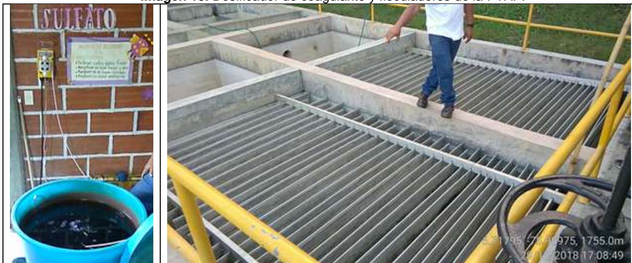
Imagen 15. Dosificador de coagulante y floculadores de la PTAP.
