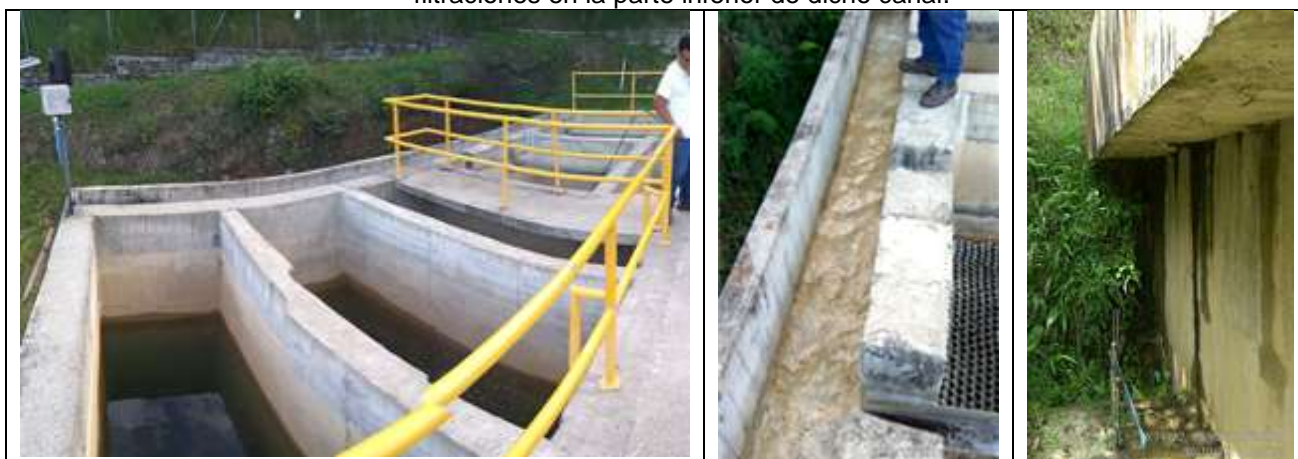
Imagen 17. Filtros de la PTAP, canal que conduce aguas sedimentadas a los filtros y filtraciones en la parte inferior de dicho canal.
