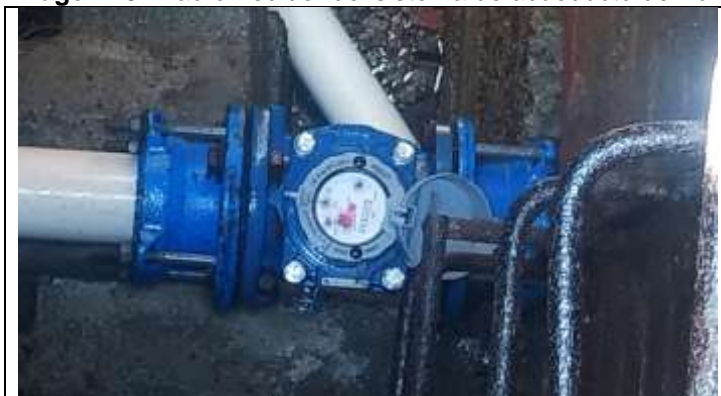
Imagen 23. Macromedidor del sistema de acueducto de Buriticá.
