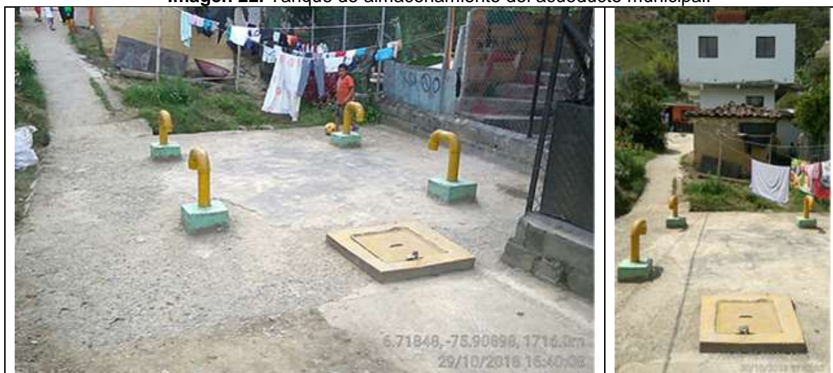
Imagen 22. Tanque de almacenamiento del acueducto municipal.
