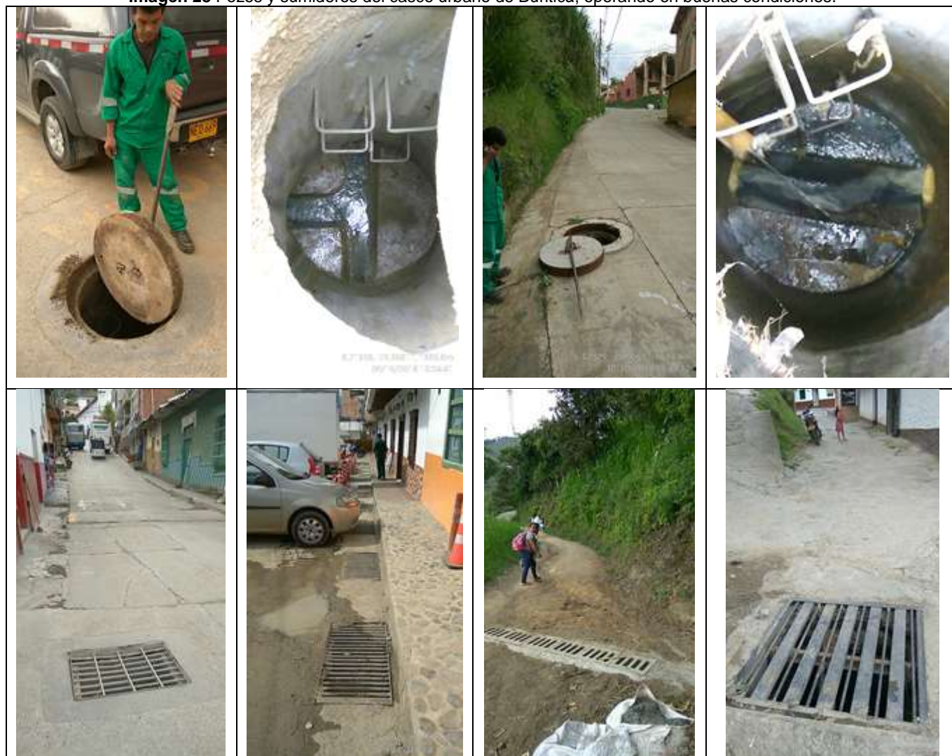
Imagen 28 Pozos y sumideros del casco urbano de Buriticá, operando en buenas condiciones.
