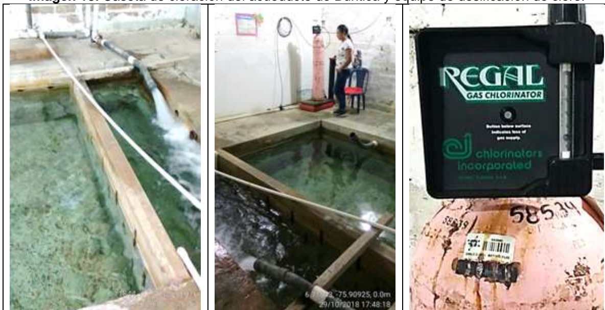
Imagen 18. Caseta de cloración del acueducto de Buriticá y equipo de dosificación de cloro.
