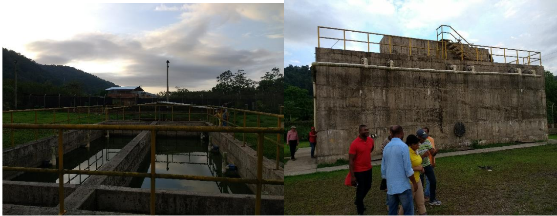
Imagen 25. PTAR- Sistema mixto UASB+ filtros percoladores
