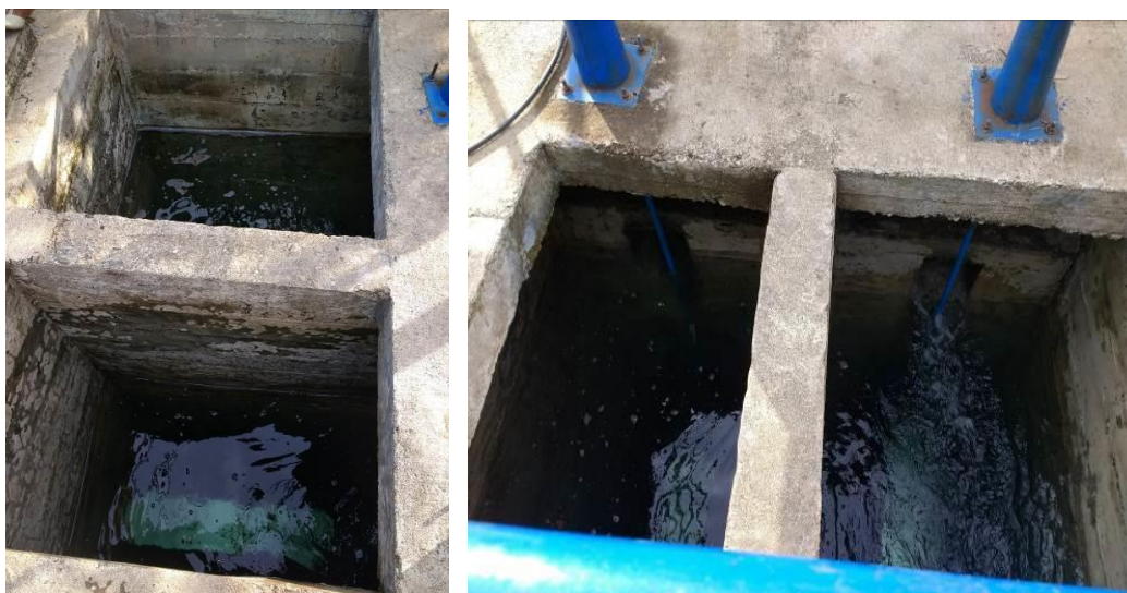
Imagen 15- Imagen 16.Filtros PTAP
