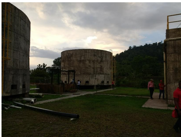
Imagen 23- Imagen 24. PTAR- Sistema mixto UASB+ filtros percoladores
