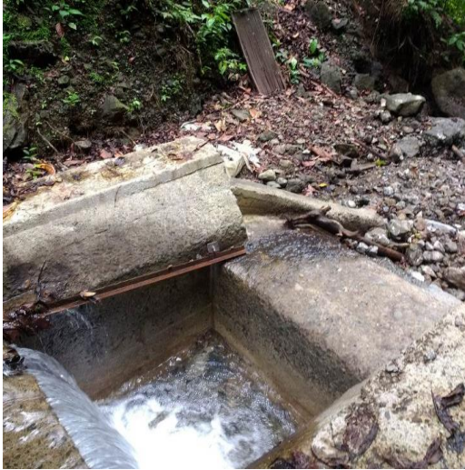
Imagen 21. Cámara de recolección captación Quebrada Brava sin rejilla
