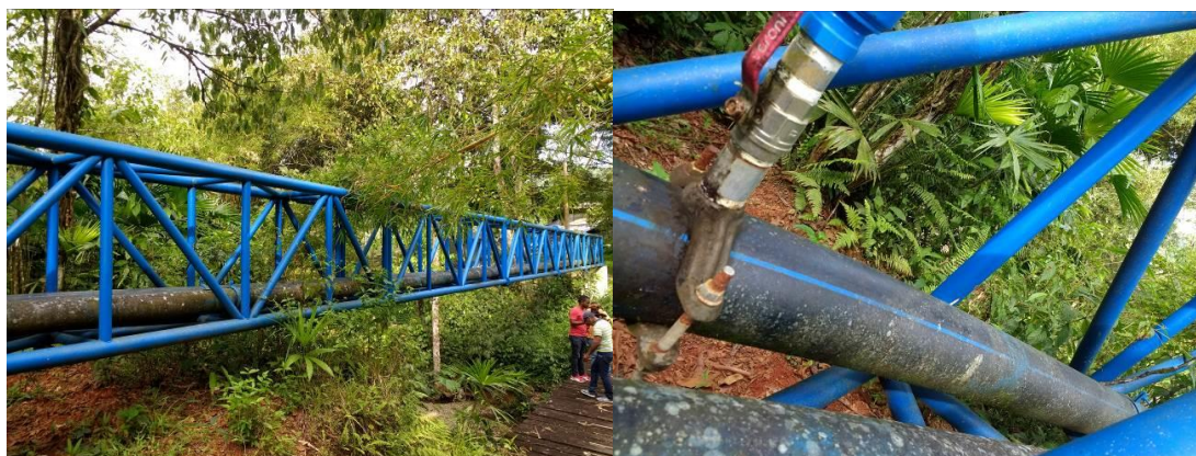
Imagen 12 - Imagen 13. Línea de aducción Quebrada Brava- Quebrada Seca Desde la T hasta la PTAP
