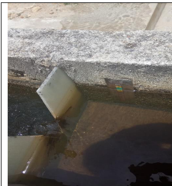
Fotografía 4 Medidor de caudal entrada PTAP
