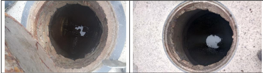
Fotografías 15 y 16 Pozos de inspección
