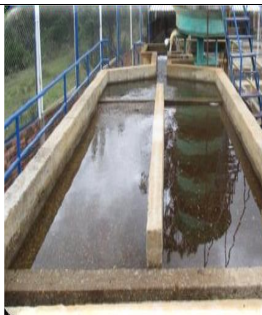
Fotografía 5 Filtro grueso dinámico
