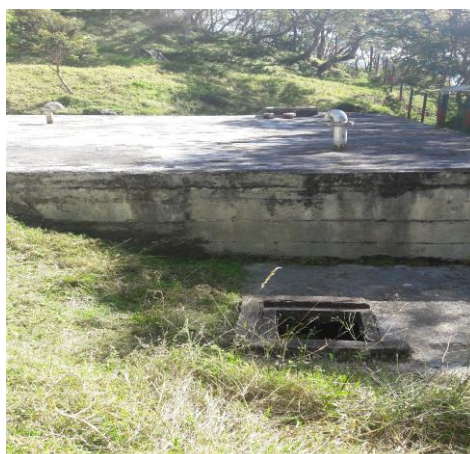
Imagen 9 Tanque de almacenamiento
