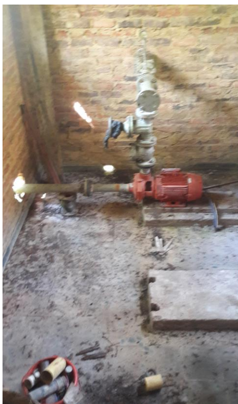
Imagen 3 Sistema de bombeo
