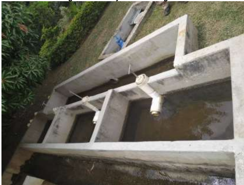
Imagen 14 Filtros y válvula de regulación
