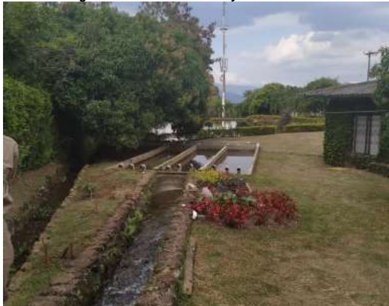
Imagen 12 Canal de aducción y filtros dinámicos
