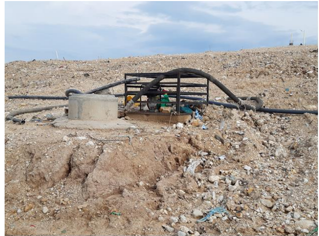
Foto 34. Vista de caja de lixiviados para su bombeo ubicada en la zona antigua
