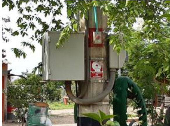
Foto 12. Señalización alarma de emergencia
