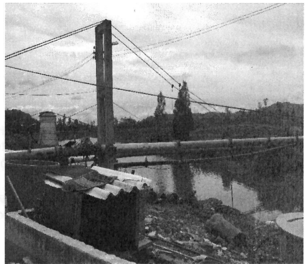
Fotografía 4. Bocatoma - Líneas de aducción de 14" y 16".
