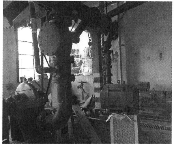
Fotografía 2. Bocatoma - Cuarto de bombas L 16".
