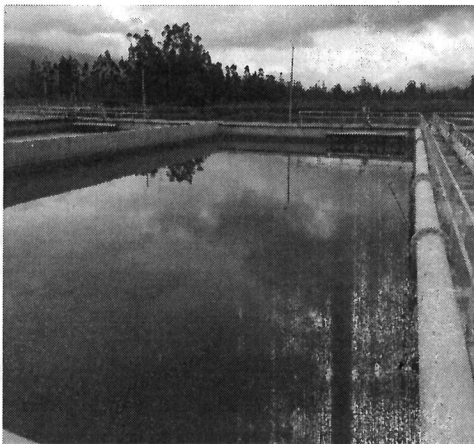
Fotografía 12. PTAR - Tanques reactores.
