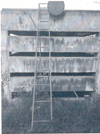
Fotografía 1. Torre de aireación PTAP Terebinto.
