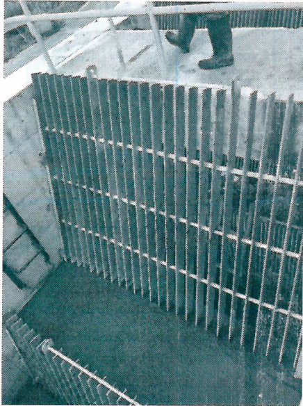
Fotografía 10. PTAR - Zona de Cribado.
