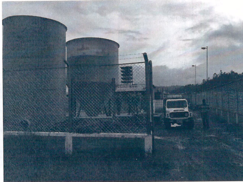
Fotografía 9. PTAP Primero de Septiembre.
