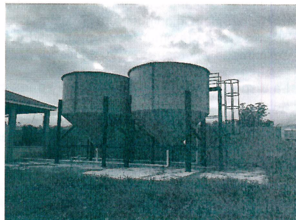
Fotografía 13. PTAR - Tanque de recolección de lodos.
