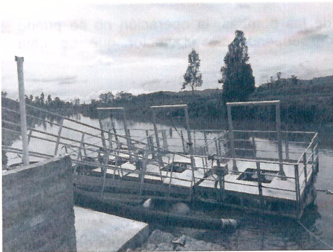
Fotografía 5. Bocatoma - Bombas sumergibles.
