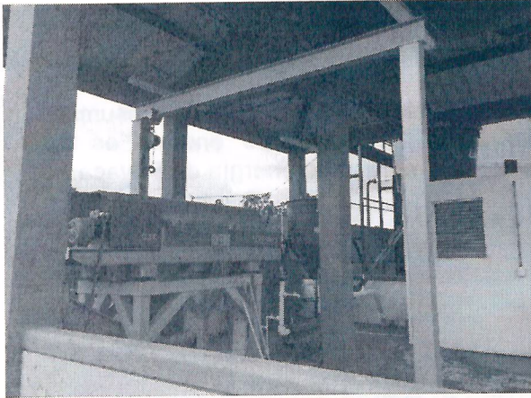
Fotografía 14. PTAR Secado de lodos.
