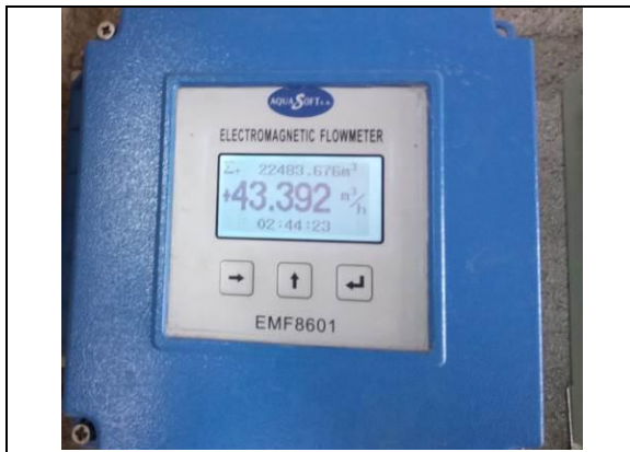
Fotografía No. 16 Medidor de Salida Albania
