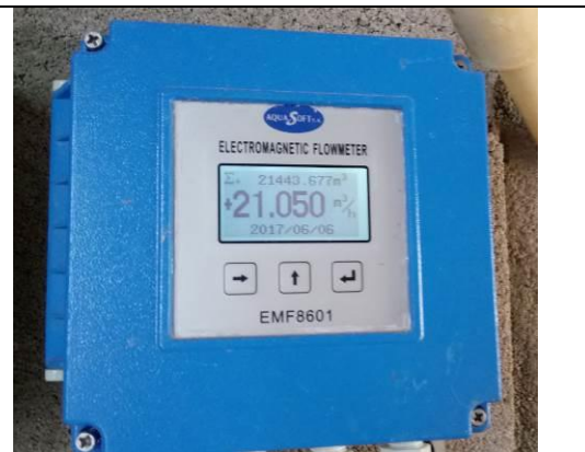
Fotografía No. 17 Medidor de Salida Cuestecitas
