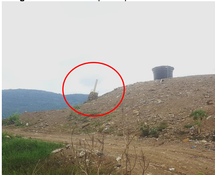
Imagen 27. Chimenea que ha perdido su verticalidad.
