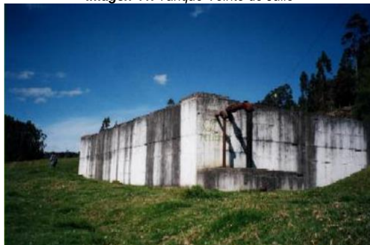
Imagen 41. Tanque Veinte de Julio
