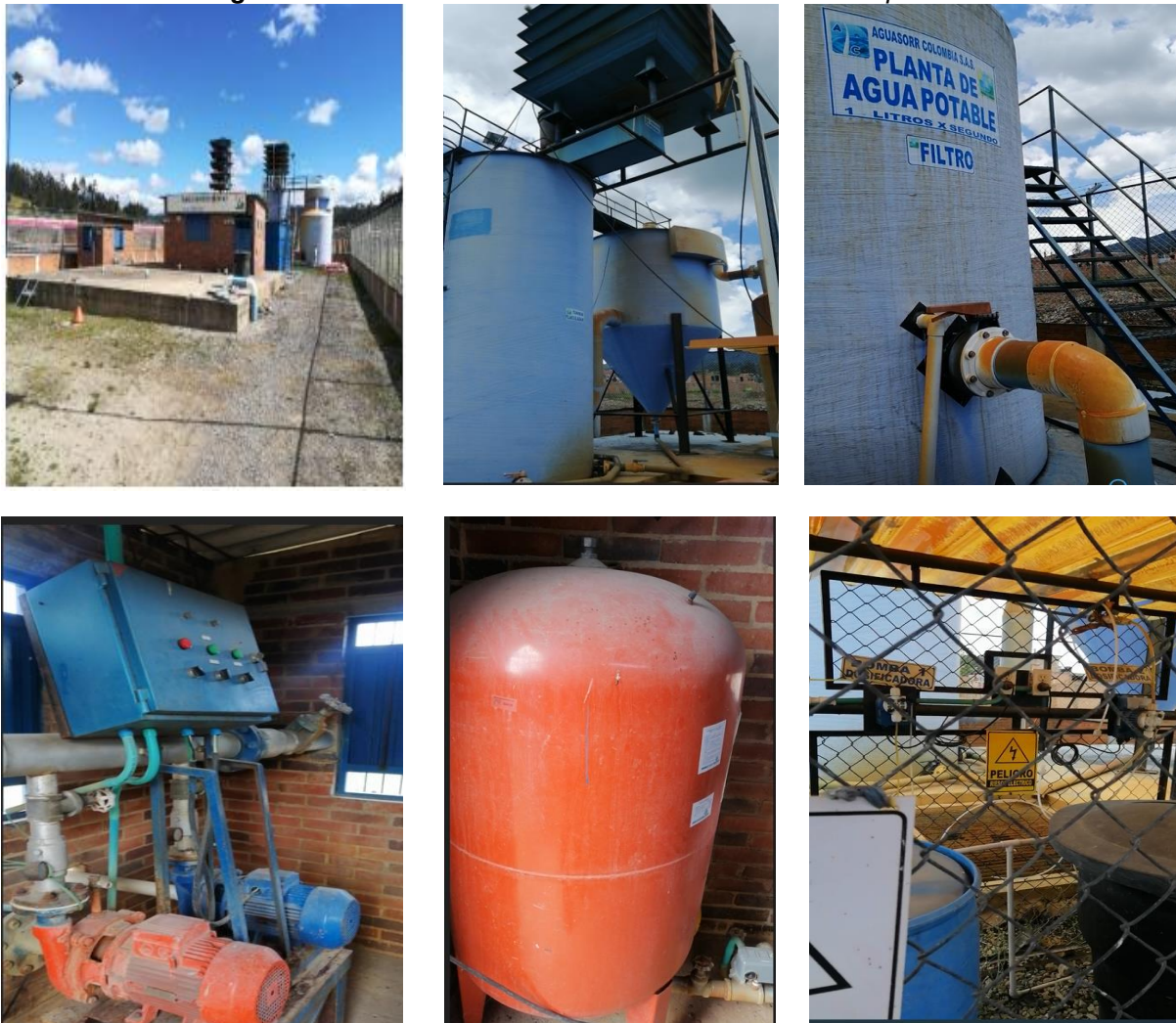
Imagen 43. Planta de tratamiento Pozo Sur – Primero de Septiembre
