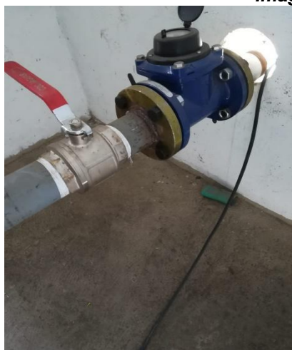
Entrada agua extraída del pozo
