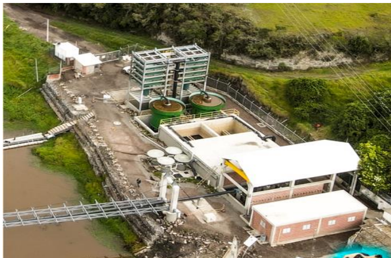
Imagen 10. Sistema de Captación La Balsa
