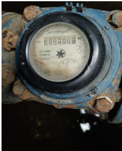
Imagen 46. Macromedidores Pozo Los Alcaparros
