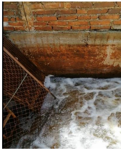
Imagen 7. Punto Tanque de Transferencia
