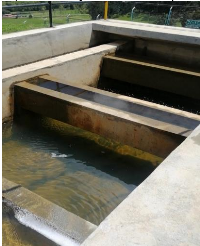
Imagen 30. Tres filtros descendentes: Arena, grava y antracita (se construyó uno – obra optimización)
