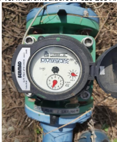
Entrada agua cruda
