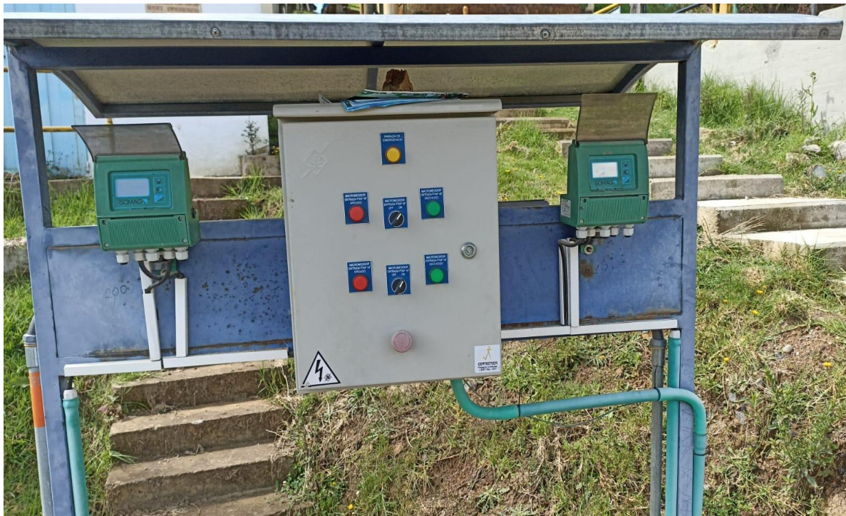
Imagen 44. Macromedidores electromagnéticos de la PTAP Terebinto
