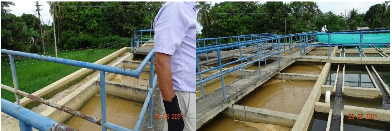
Imagen 18 Cámaras de Floculación
