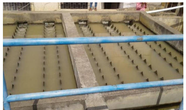
Imagen 65 Desarenadores PTAP Santa Cruz de Lorica – Córdoba
