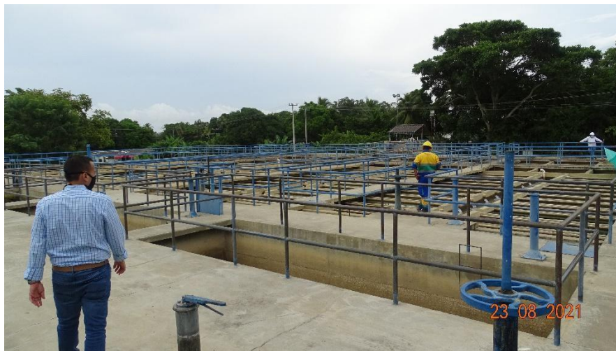
Imagen 16 Planta de Tratamiento Cereté – Córdoba
