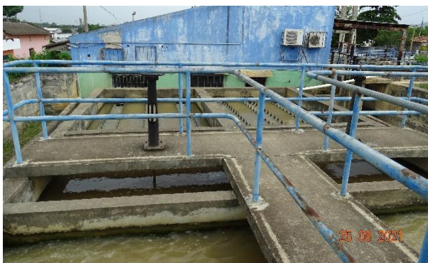
Imagen 64 Desarenadores PTAP Santa Cruz de Lorica – Córdoba
