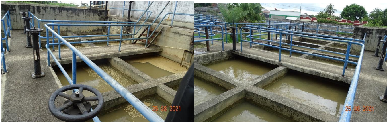
Imagen 70 Cámaras de Floculación
