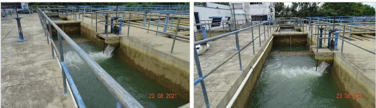
Imagen 24 Tanques de Filtración
