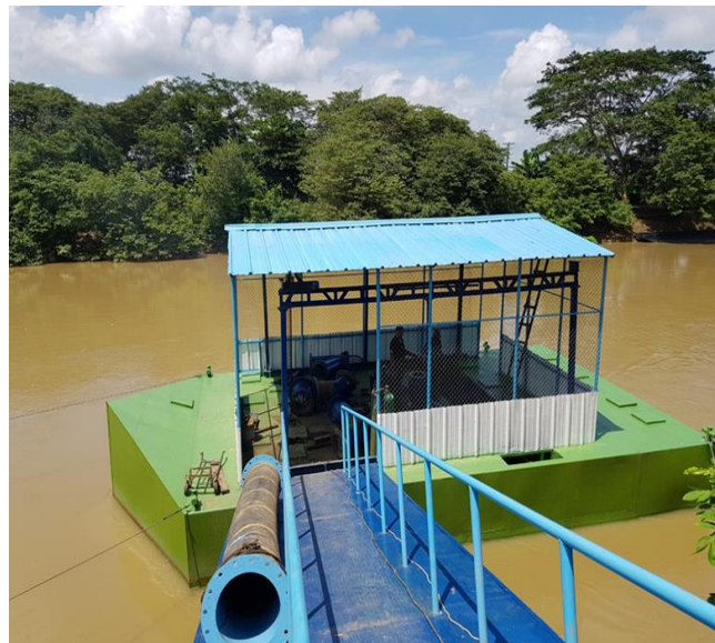
Imagen 10 Captación Río Sinú - Sistema de Acueducto Regional Sur – Medio Sinú
