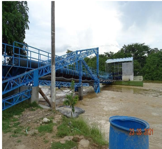
Imagen 9 Captación Río Sinú - Sistema de Acueducto Regional Sur – Medio Sinú
