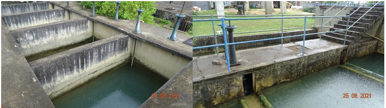
Imagen 73 Tanques de Filtración
