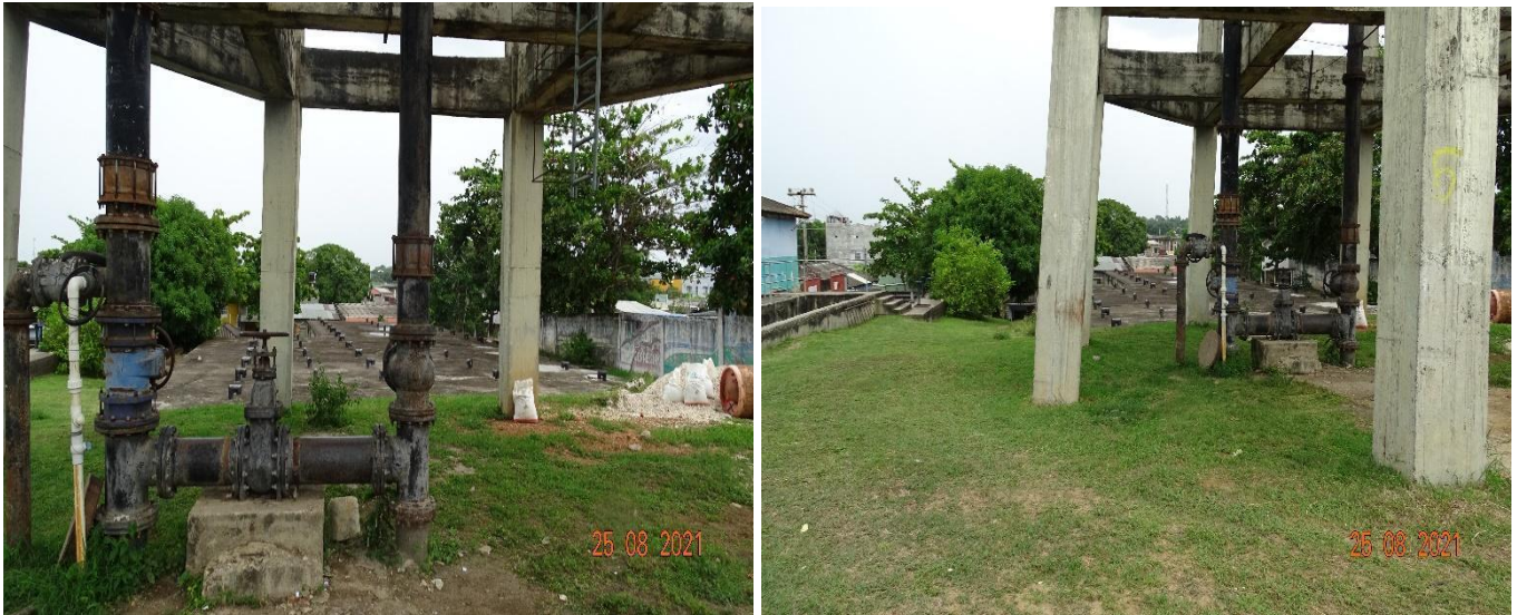
Imagen 74 Tanques de almacenamiento
