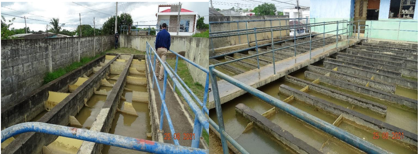
Imagen 69 Cámaras de Floculación
