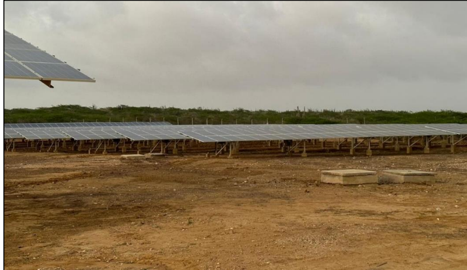
Ilustración 17 Paneles solares – Nazareth - Helios
