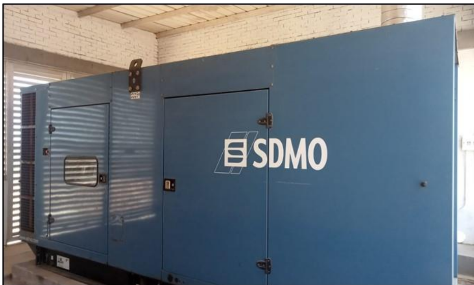
Ilustración 16 Grupo electrógeno Doosan 455 kW no operativo – Nazareth - Helios
