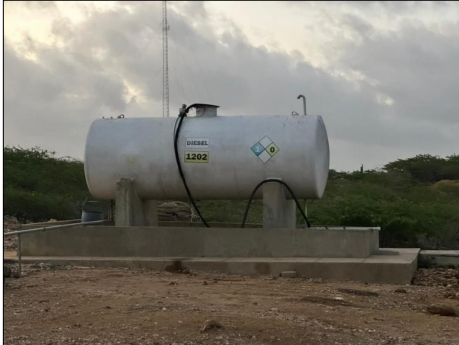
Ilustración 19 Tanque de almacenamiento de combustible – Nazareth - Helios
