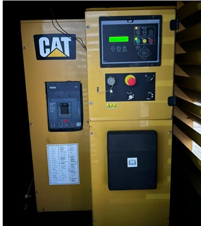
Ilustración 15 Grupo electrógeno Caterpillar 600 kW – Nazareth - Helios
