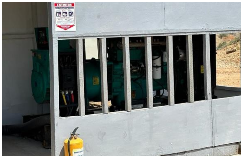
Ilustración 24 Grupo electrógeno Cummins 200 kW Cabo de la Vela
