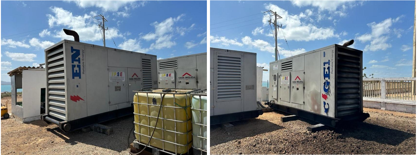
Ilustración 23 Grupos electrógenos Perkins 1 – 2 500 kW Cabo de la Vela
