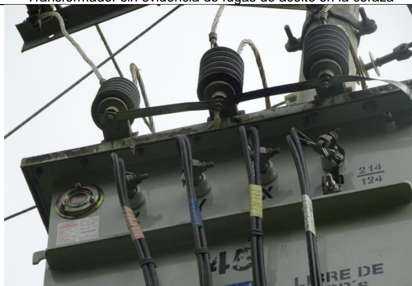
Bornes en baja y media tensión sin daños físicos
