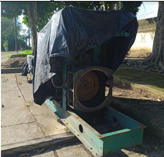
Unidad 5 - Unidad de generación CUMMINS QST30G3 (Fuera de servicio, se retiró de la casa de máquinas)
