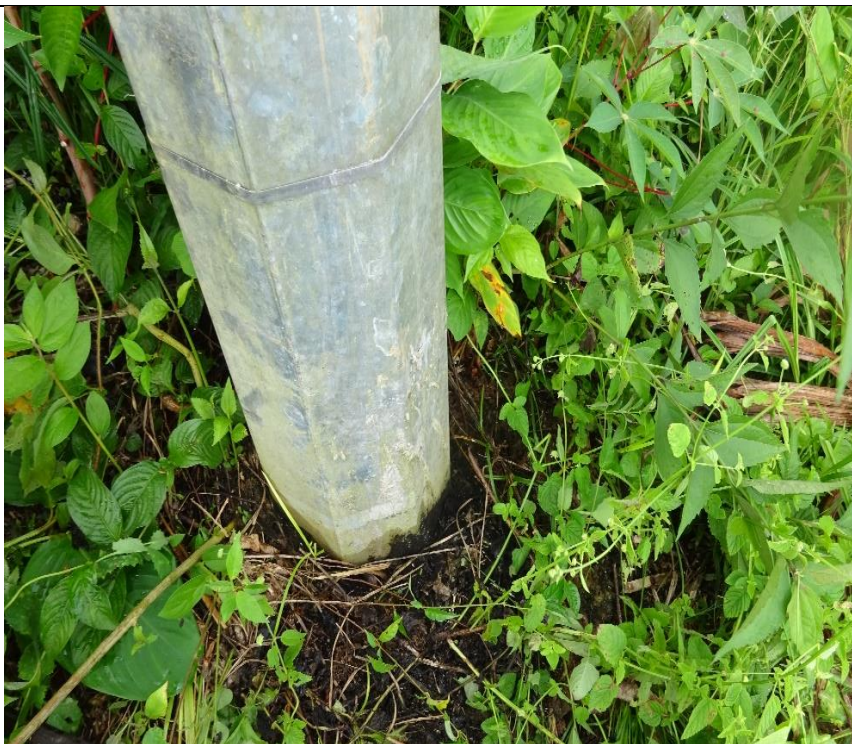
Poste donde se encuentra instalado el transformador sin evidencia de fugas de aceite en la base Inspección visual y registro de redes en baja tensión
