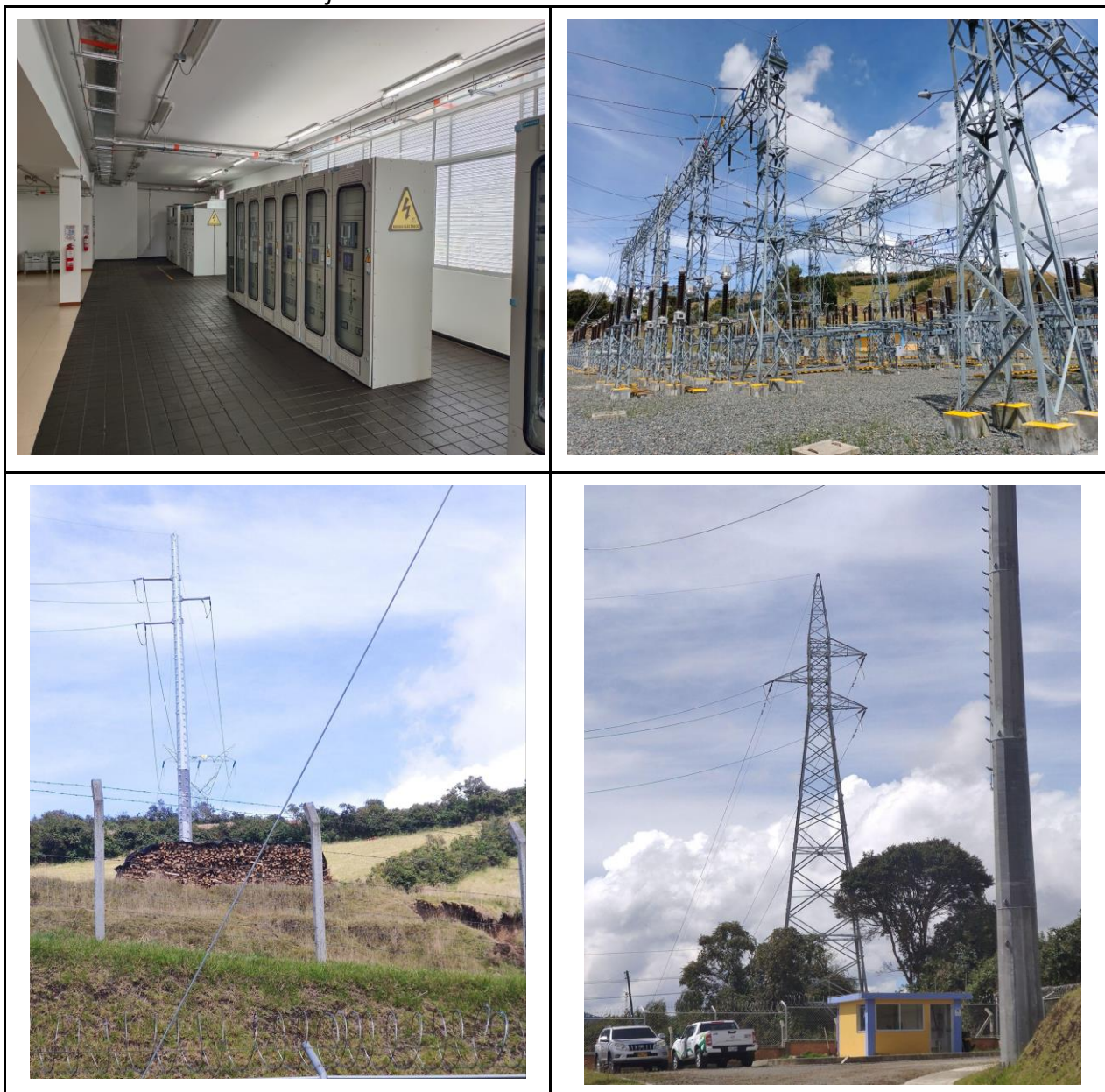
Figura 24. Registro fotográfico de unidades constructivas relacionadas a los proyectos ejecutados en la Subestación Jardinera.
