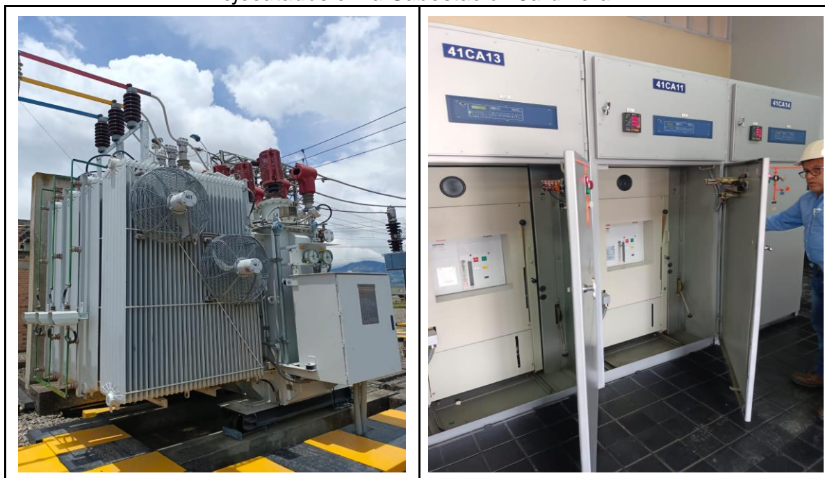
Figura 25. Registro fotográfico de unidades constructivas relacionadas a los proyectos ejecutados en la Subestación Jardínera.
