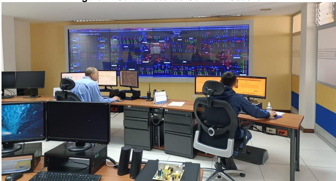
Figura 7. Centro Local de Control – Cedenar.
