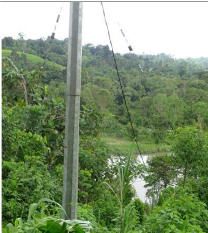
Red de baja tensión que alimenta caja de abonados en buen estado
