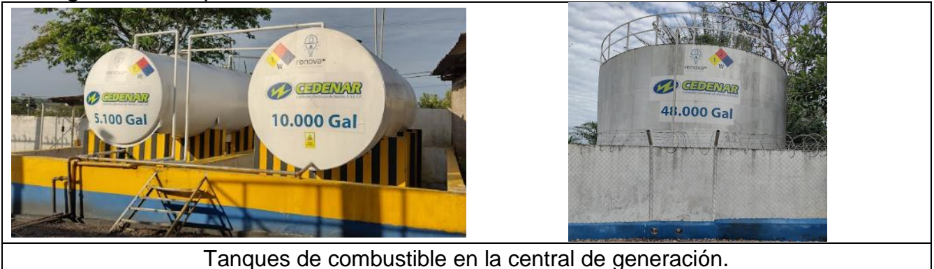
Figura 51. Tanques de almacenamiento de combustible en la central de generación.
