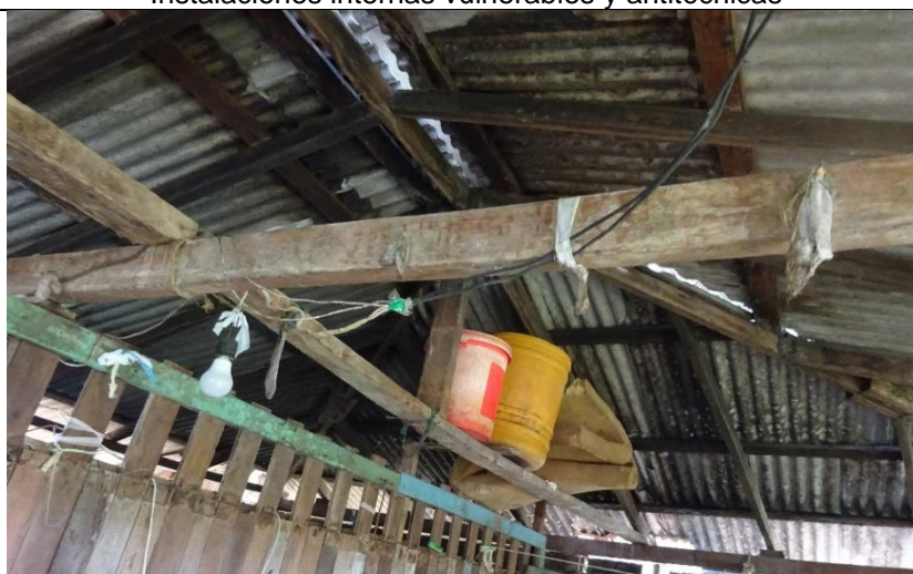
Instalación eléctrica interna vulnerable
