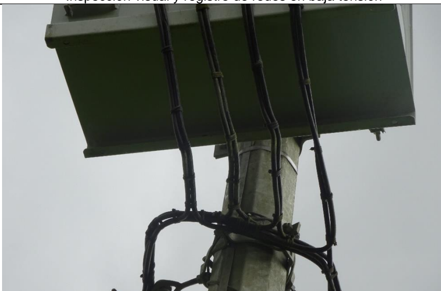
Conexión de la red de baja tensión desde transformador
