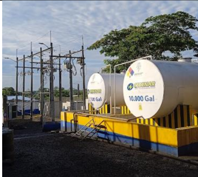
Subestación y tanques de combustible central de generación Puerto Leguízamo
