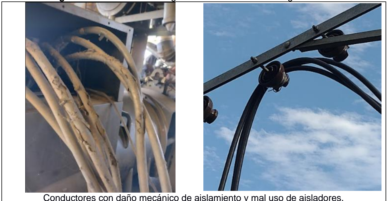
Figura 52. Evidencias de irregularidades en la central de generación.
