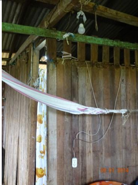
Instalación eléctrica internas vulnerable
