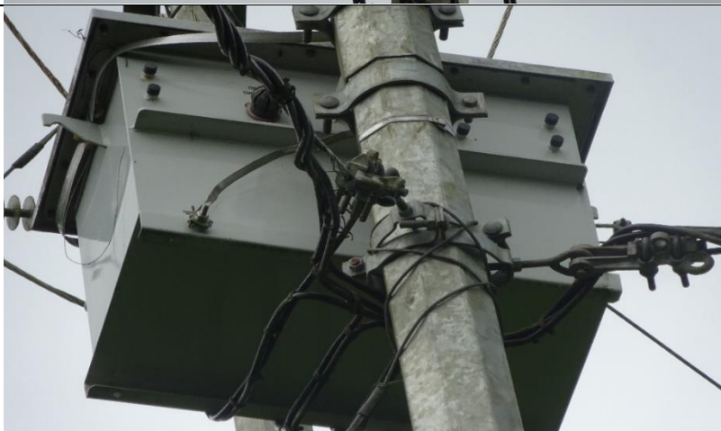
Transformador sin evidencia de fugas de aceite en la coraza
