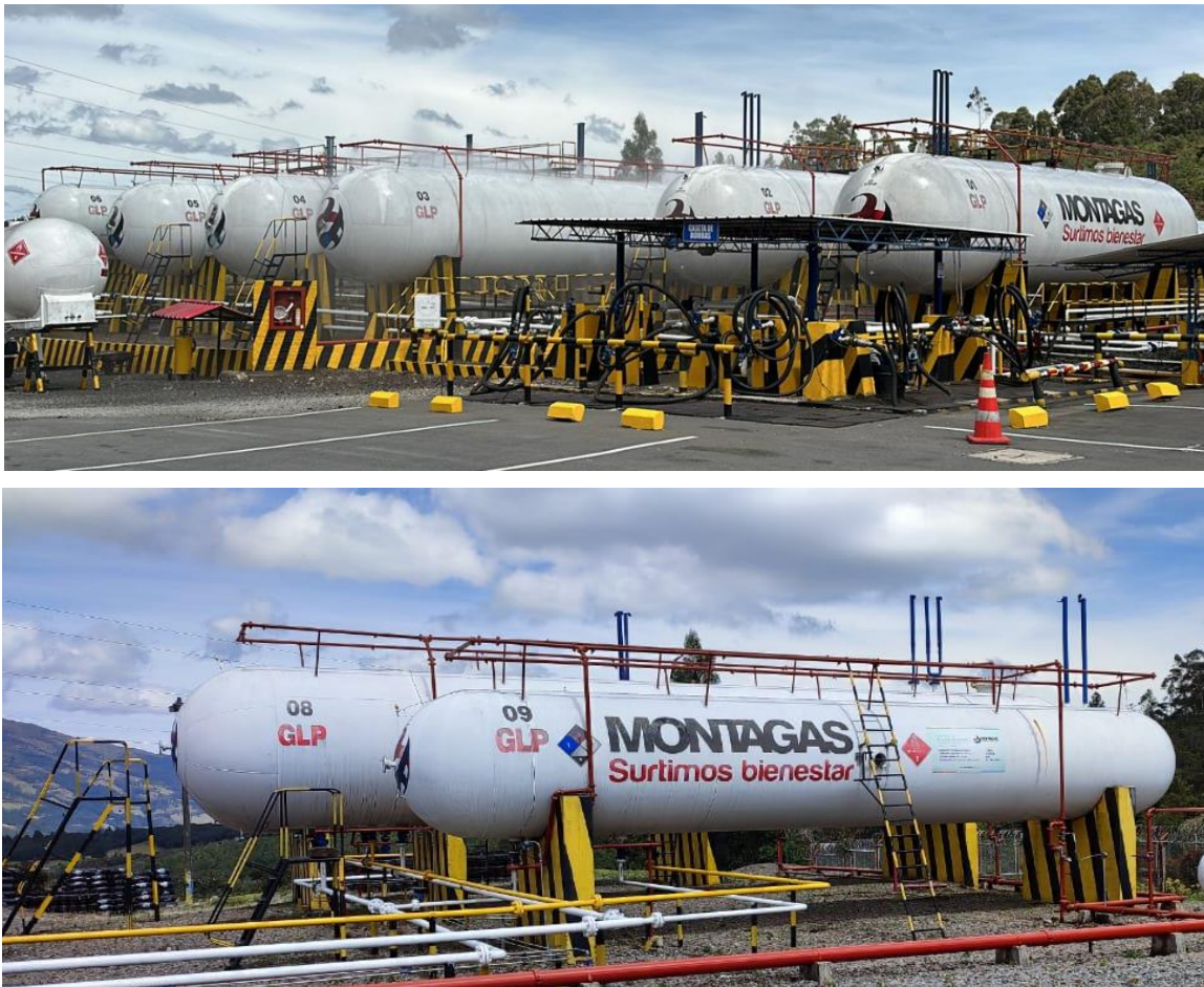
Figura 8. Tanques estacionarios de almacenamiento de GLP de la planta de envasado de la empresa MONTAGAS S.A. E.S.P. en San Juan de Pasto, Nariño
