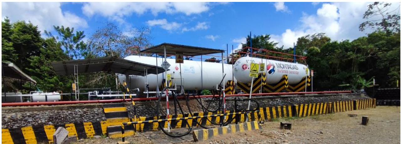
Figura 7. Tanques estacionarios de almacenamiento de GLP de la planta de envasado de la empresa MONTAGAS S.A. E.S.P. en San Andrés de Tumaco, Nariño
