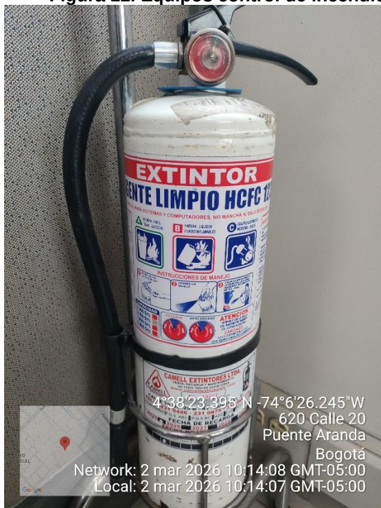
Figura 12. Equipos control de incendios
