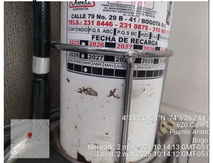
Figura 11. Equipos control de incendios
