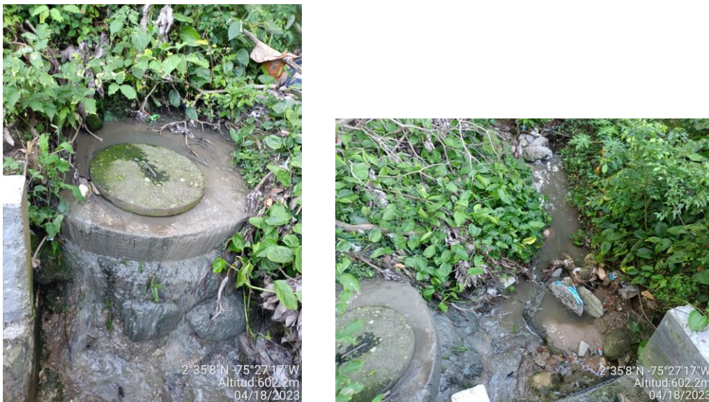
Fuente: visita de inspección del 18 al 20 de abril de 2023 a EMUSERHOBO S.A. E.S.P.
