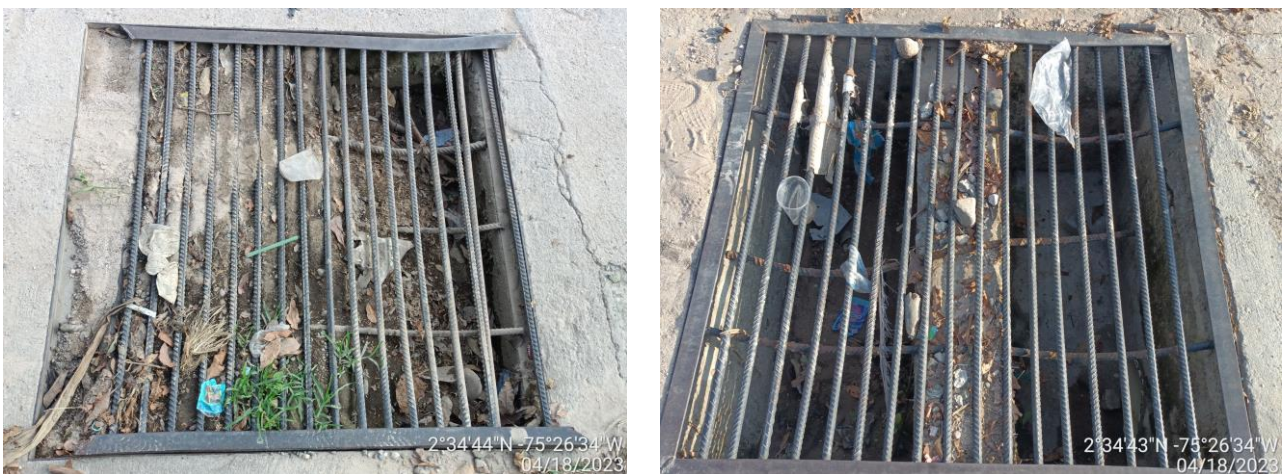
Imagen 19. Sumideros de aguas lluvias colmatados.
