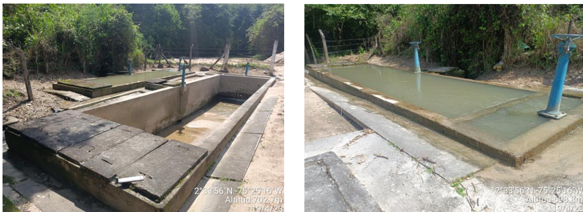
Imagen 8. Desarenadores en operación (derecha) y mantenimiento (izq. inferior) de EMUSERHOBO S.A. E.S.P.
