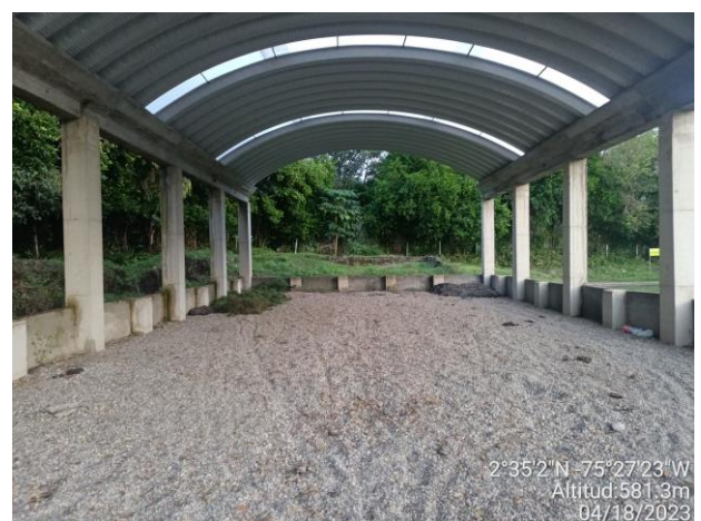
Caseta de secado de lodos.
