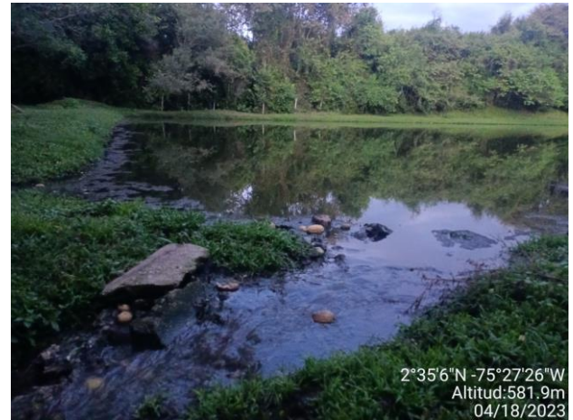
Vertimiento laguna de maduración facultativa 5 (Ruptura)
