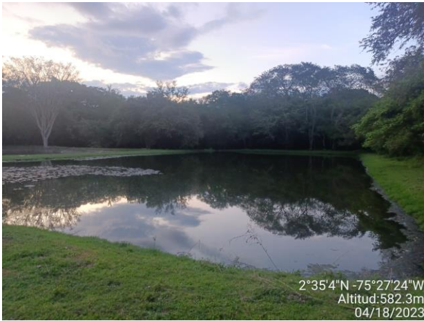
Laguna de maduración facultativa 5
