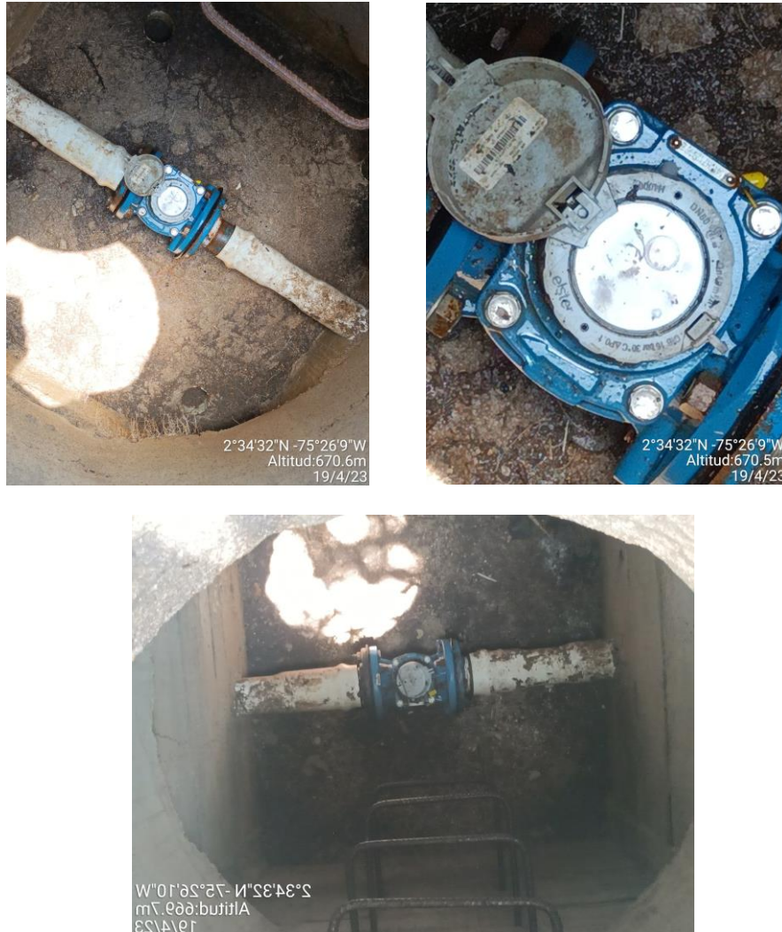
Imagen 14. Macro medidores a la salida de los dos tanques semienterrados de almacenamiento de agua tratada.
