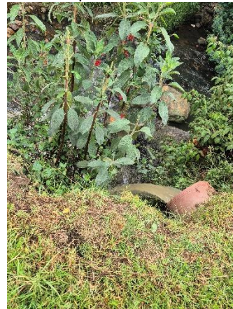
Emisario Final – Fuente receptora Rio Bogotá
