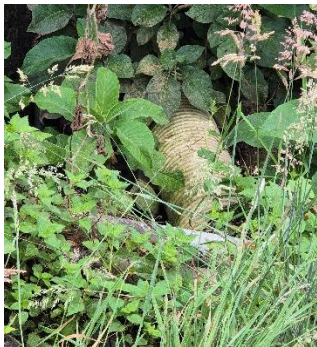
Vertimiento Quebrada Arrayanes - Fuente Receptora Quebrada Arrayanes
