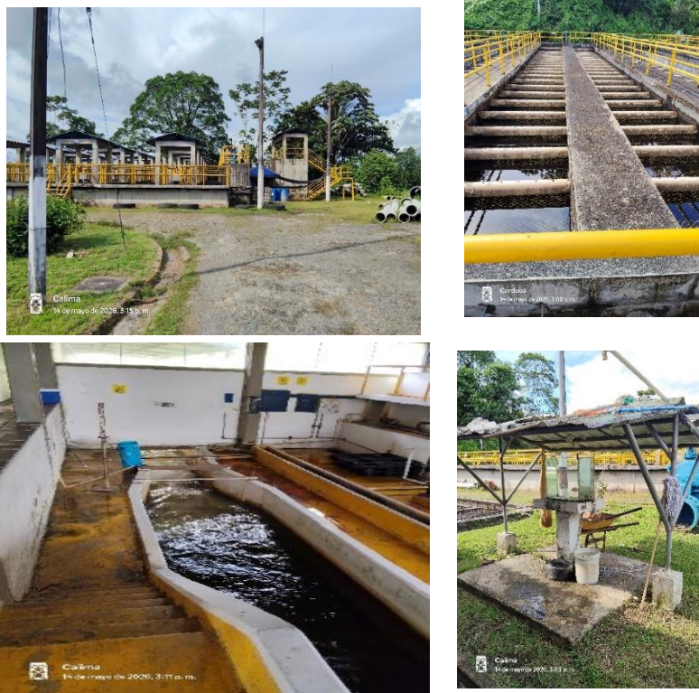
Imagen 7: Registro imágenes PTAP Venecia
