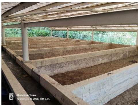
Imagen 19: Lecho de tratamiento de lodos PTAR
