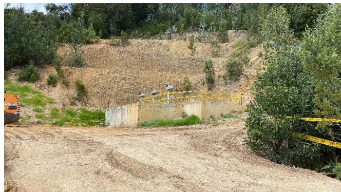
Agua lodo proveniente de sedimentadores
