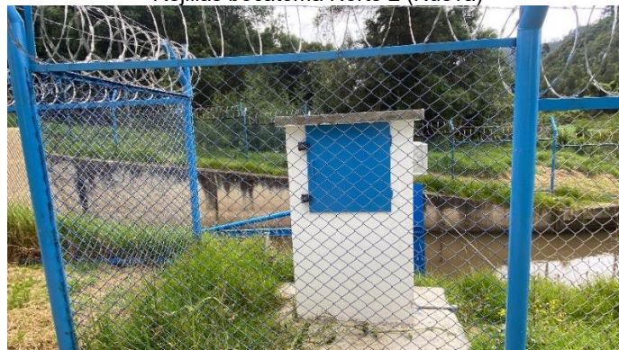
Estación monitoreo bocatoma Norte 2 (Nueva)
