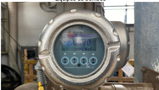
Medidor de caudal equipo de bombeo
