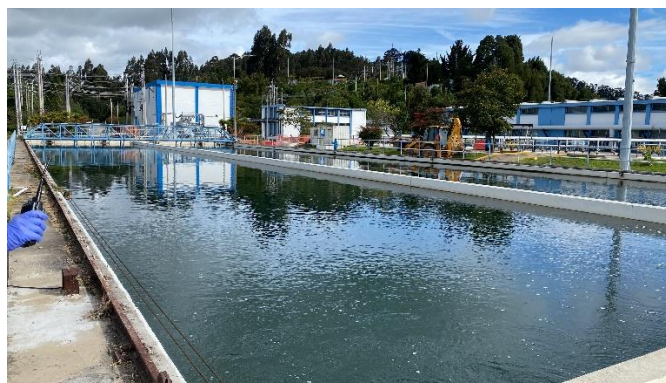
Unidades de sedimentación optimizada
