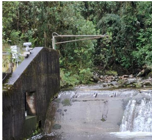
Sistema de captación pozo 3
