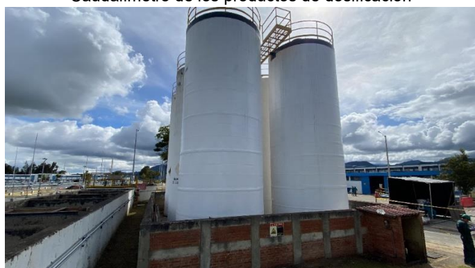
Tanques de almacenamiento coagulantes
