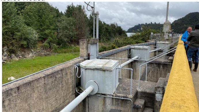
Compuertas de rebose
