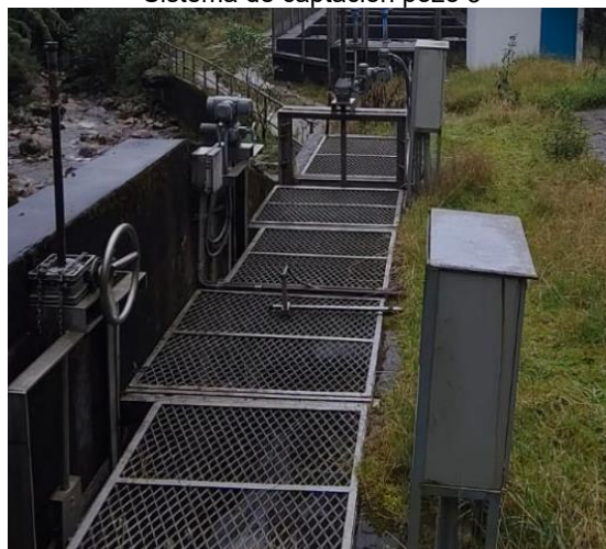
Canal de derivación pozo 3
