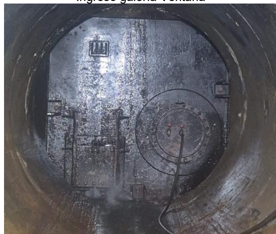
Fuga tapón túnel
