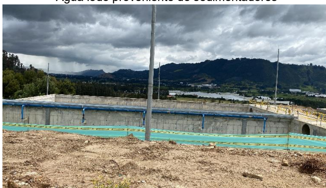
Tanques de recirculación lavado de filtros
