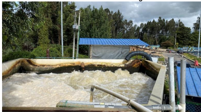
Cámara de preoxidación mediante soplador
