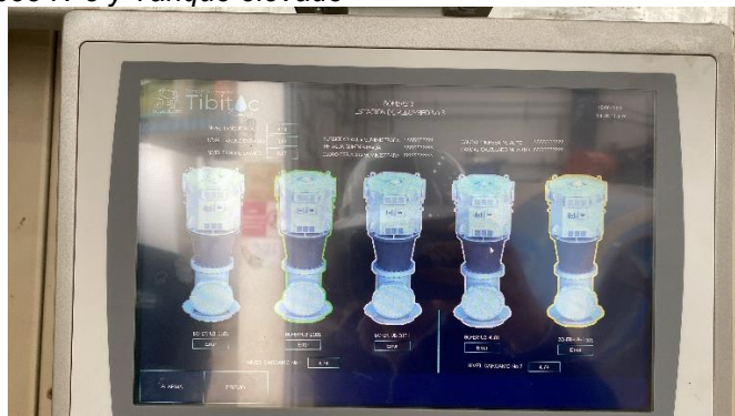
Sistema de operación estación de bombeo N°3
