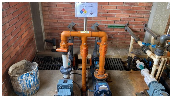
Bombas dosificadoras PAC
