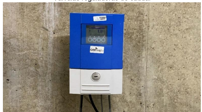
Instrumento de control de caudal
