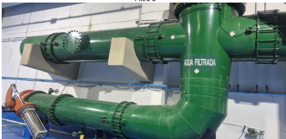
Salida agua filtrada
