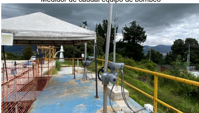
Actuadores tanque elevado
