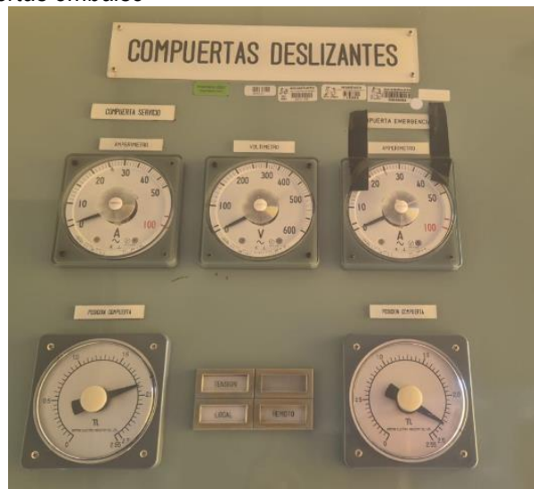
Mecanismos de accionamiento compuertas
