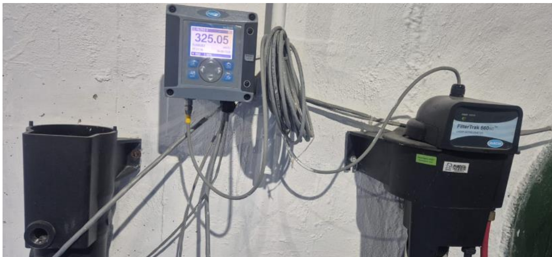
Medidor de presión y turbidímetro filtro 10
