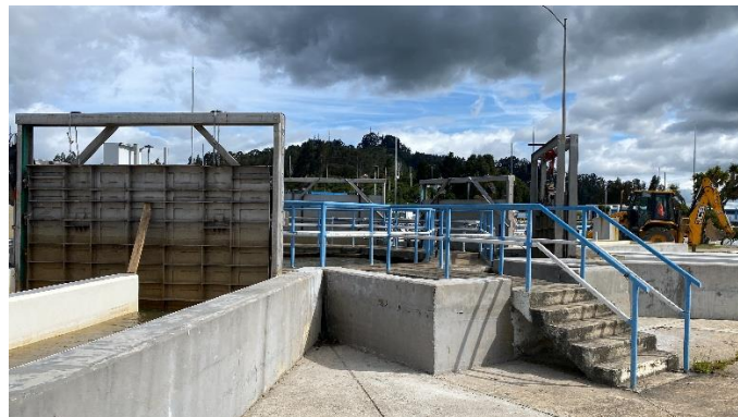
Estructura de repartición (Pulpo)
