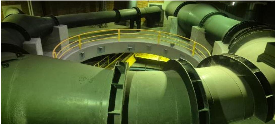
Tubería de descarga estación de bombeo
