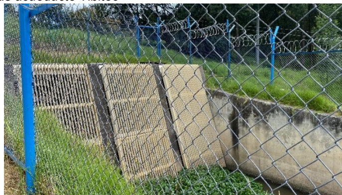
Rejillas bocatoma Norte 2 (Nueva)
