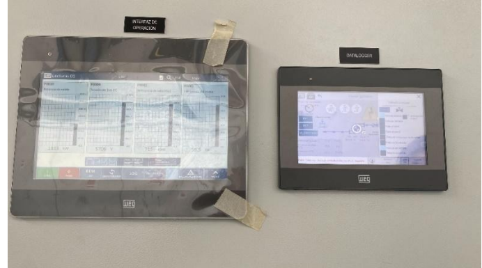
Sistemas de control de operación
