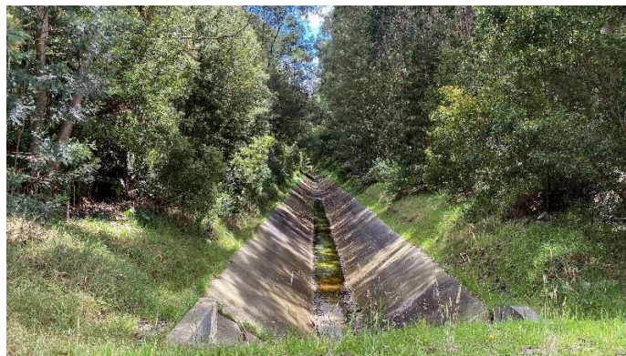
Canal de conducción de agua cruda
