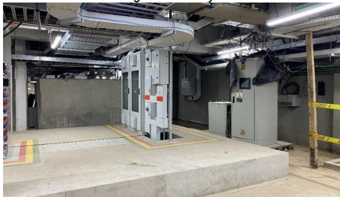
Optimización sistema eléctrico estaciones de bombeo
