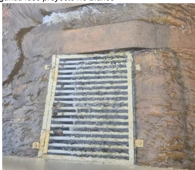
Bocatoma de fondo Barro – Plumaraña
