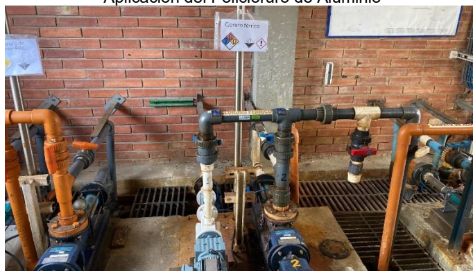
Bombas dosificadoras Cloruro Férrico
