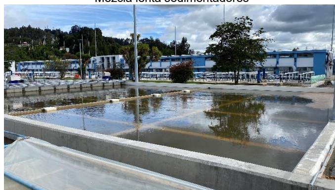
Unidades de sedimentación optimizada
