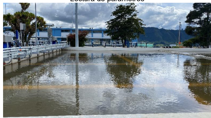
Unidades de sedimentación optimizada
