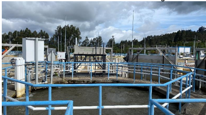
Estructura de repartición (Pulpo)
