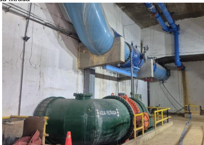
Tubería descarga filtro 96 pulgadas
