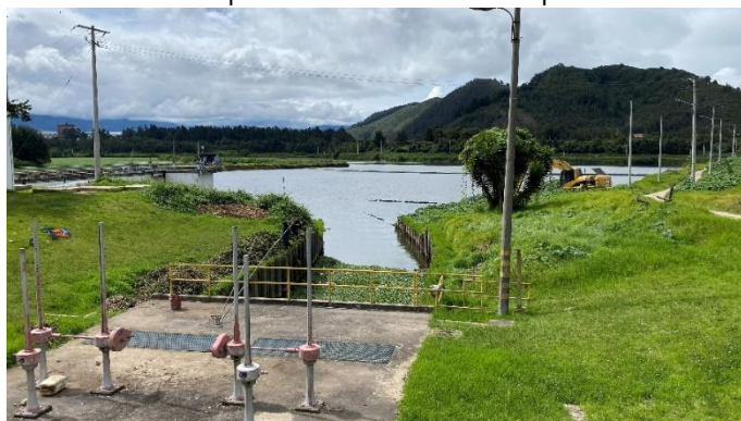
Compuertas entrada estación de bombeo
