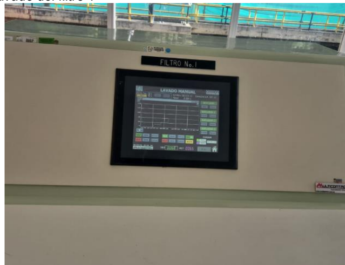
Centro de control filtro 14
