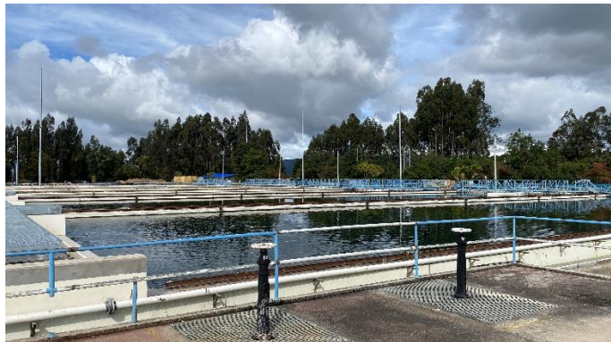
Unidades de sedimentación optimizada
