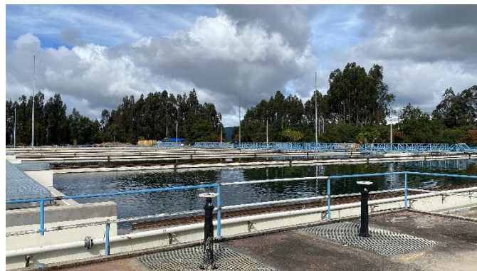
Unidades de sedimentación optimizada
