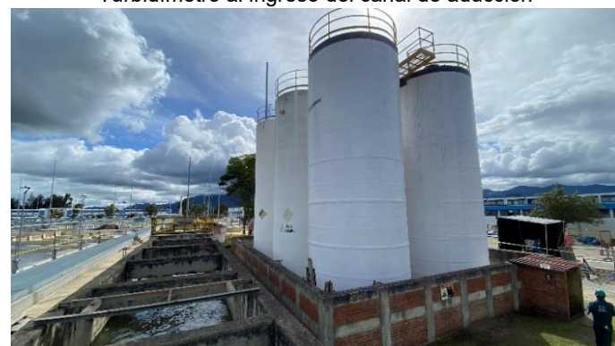
Tanques de almacenamiento coagulantes
