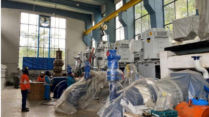
Motores instalados bombeo de agua cruda
