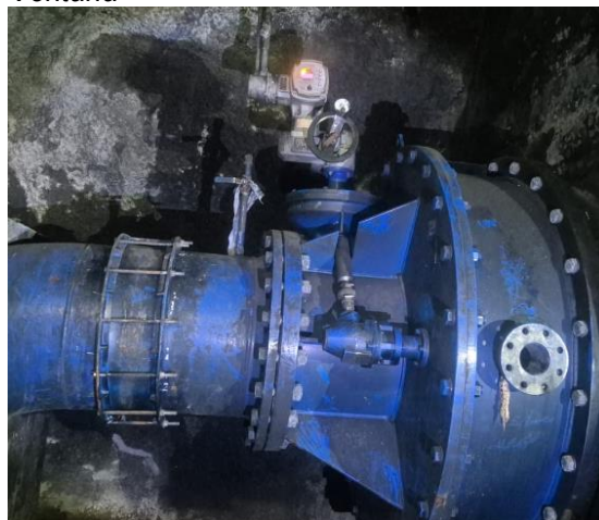
Válvula HB 24" drenaje túnel
