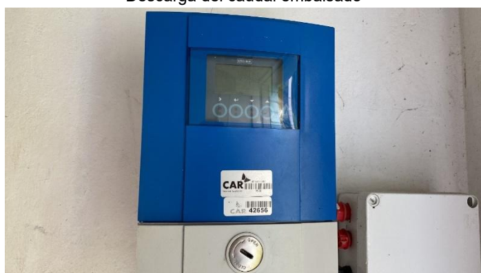
Instrumento de control de caudal
