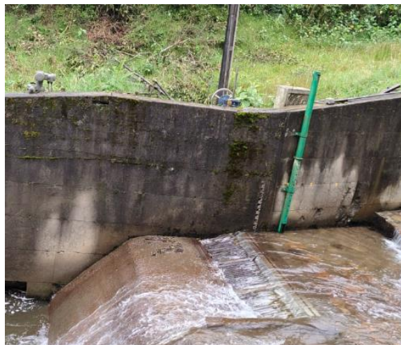
Sistema de captación pozo 4
