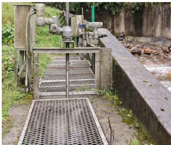
Canal de derivación pozo 4
