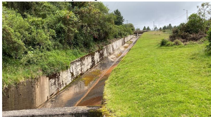
Salida de las compuertas de rebose
