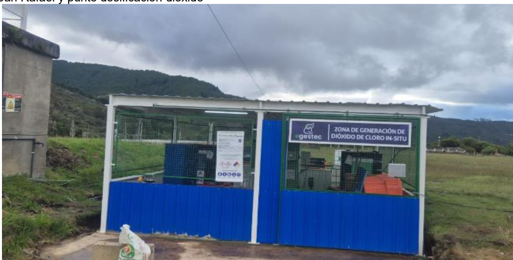
Zona de generación de dióxido de cloro
