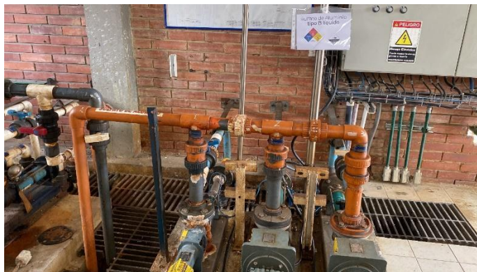
Bombas dosificadoras Sulfato de Aluminio
