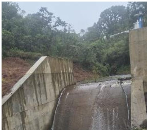
Estructura de captación El Mangón
