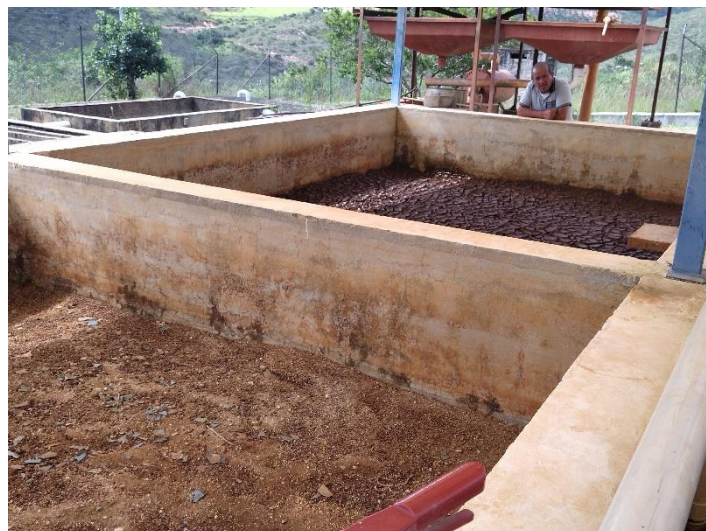
Imagen 12. Lechos de secado de lodos
