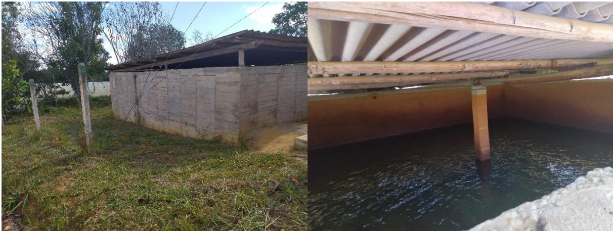
Imagen 13. Tanques de almacenamiento
