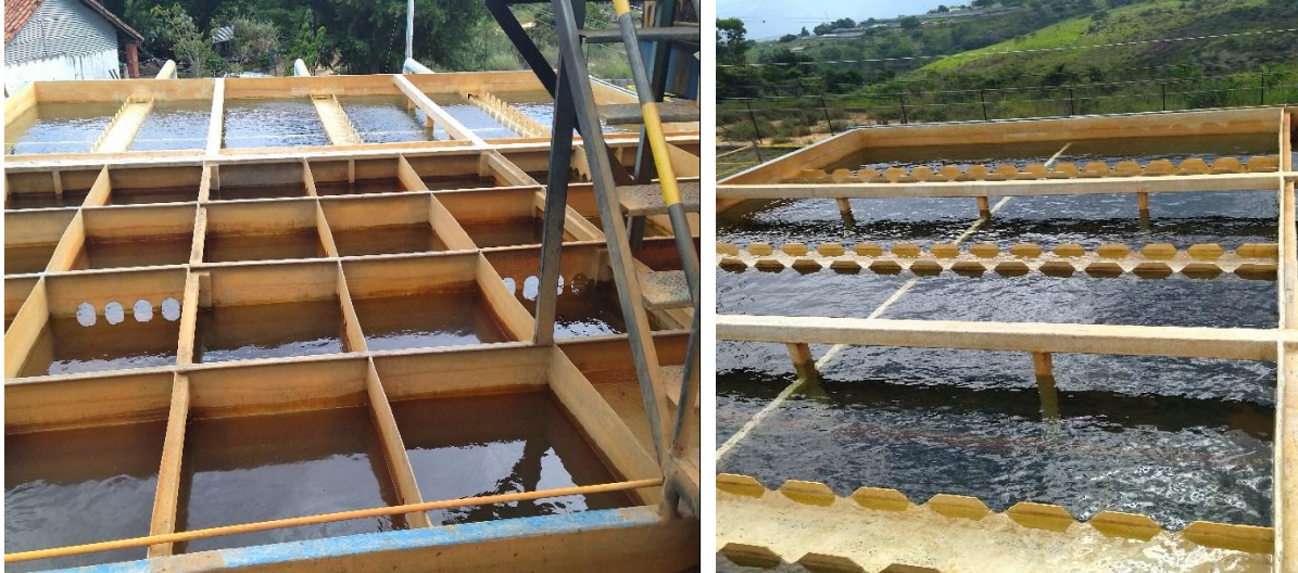
Imagen 9. Módulo de floculación y sedimentación.
