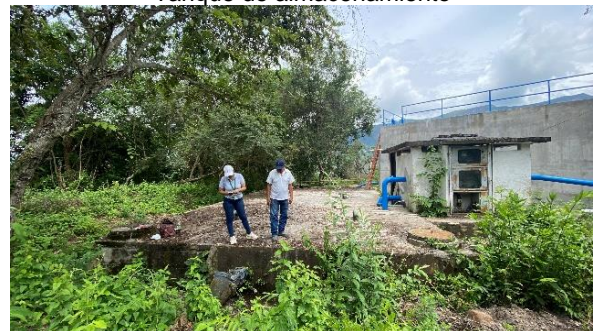
Tanque principal de distribución
