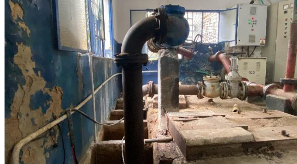
Línea de impulsión bomba sumergible
