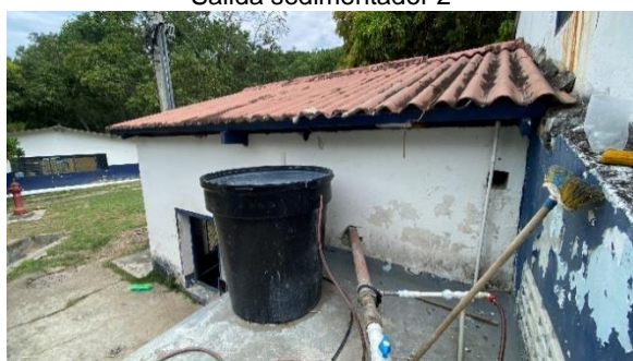
Dosificación cloro granulado
