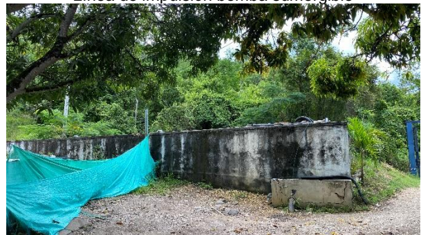
Tanque de almacenamiento
