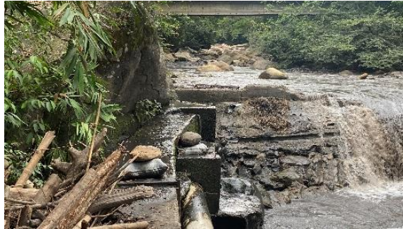
Aducción bocatoma al desarenador
