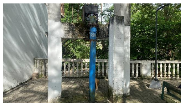
Tubería de llegada red de distribución
