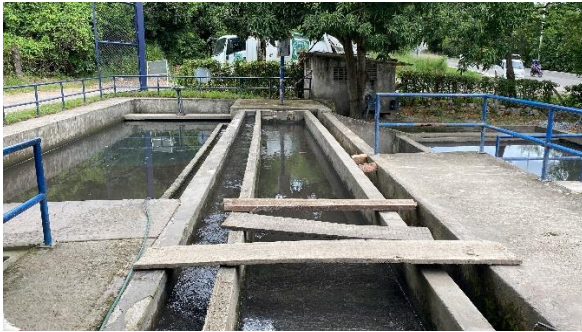
Floculador con fallas estructurales
