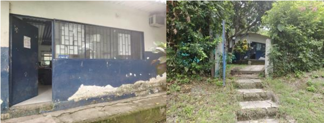
Fuente: Información Empoapulo S.A. E.S.P., visita de inspección
