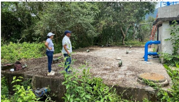
Tanque principal de distribución
