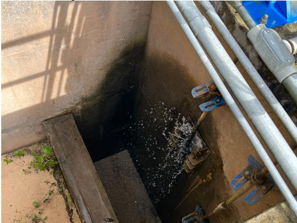
Imagen 29. Filtraciones en las unidades de filtración.
