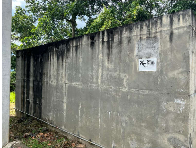
Imagen 32. Tanques de almacenamiento Puriblock II y Cinco Mil.
