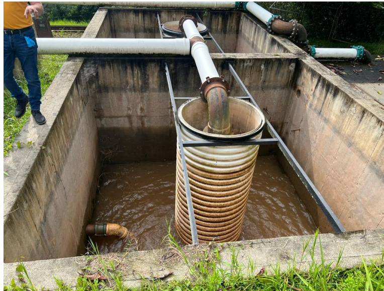
Imagen 43. Tratamiento de lodos.
