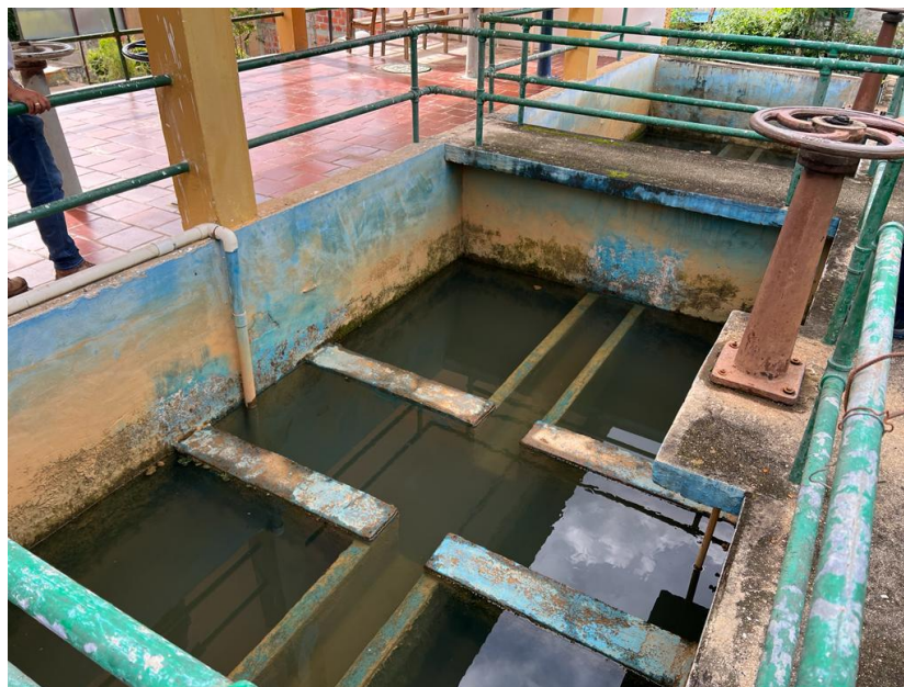
Imagen 17. Unidades de filtración.
