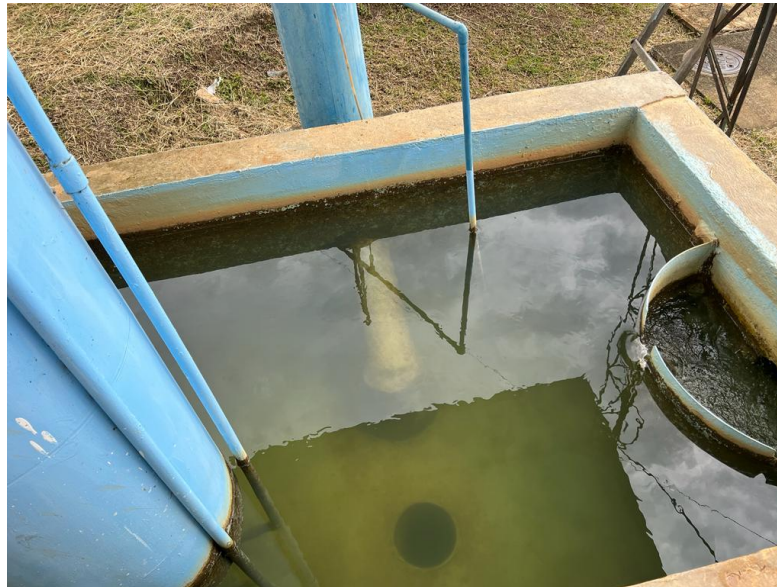
Imagen 22. Unidades de filtración.
