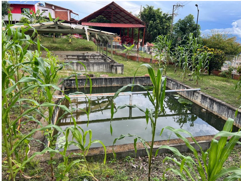
Imagen 42. Tratamiento de lodos.
