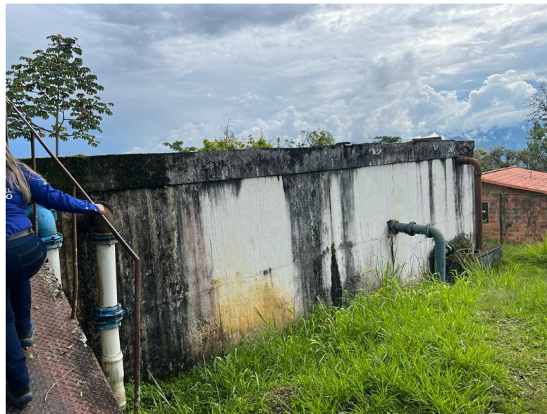
Imagen 33. Tanques de almacenamiento Puriblock II y Cinco Mil.
