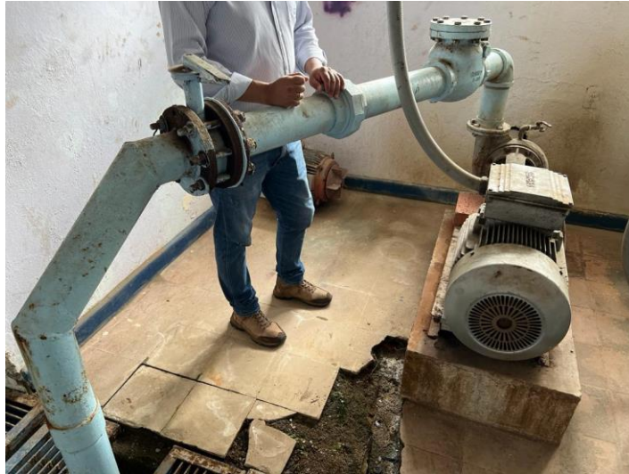
Imagen 34 Estación de bombeo PTAP
