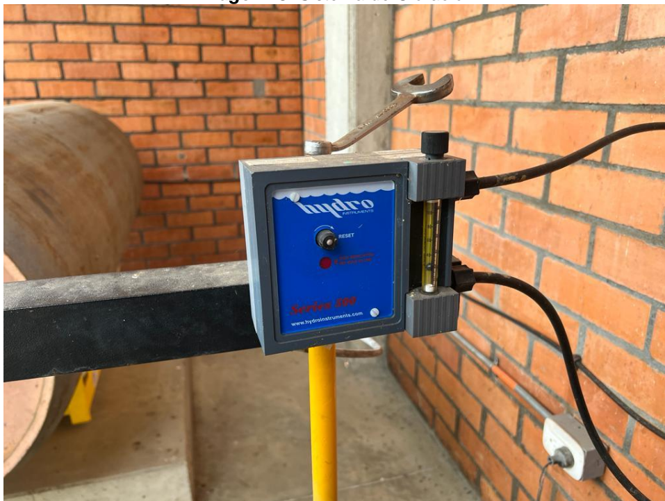
Imagen 28. Sistema de Cloración.
