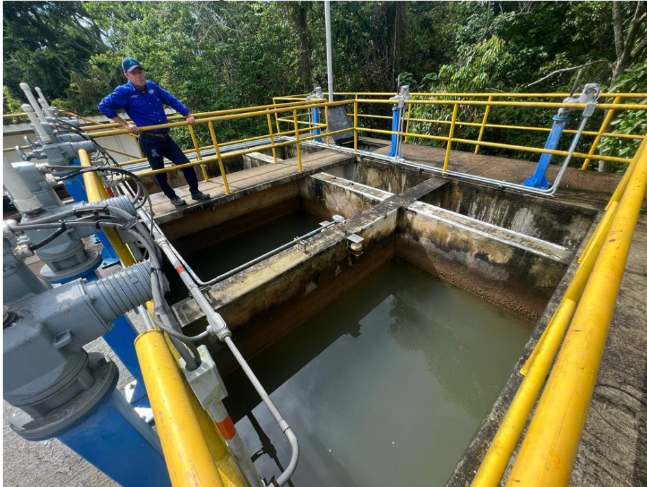
Imagen 27. Unidades de Filtración.
