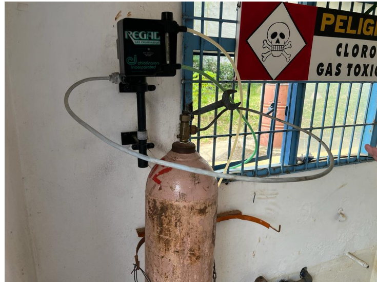
Imagen 18. Sistema de Cloración.
