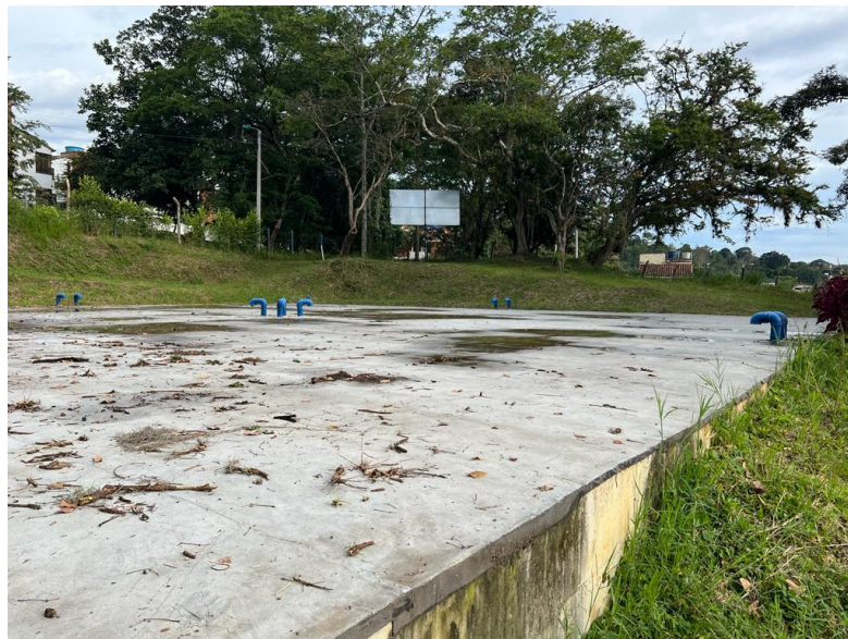
Imagen 31. Tanques de almacenamiento PTAP Convencional.
