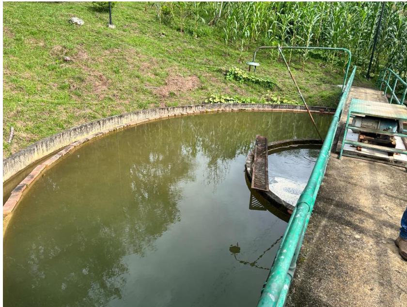
Imagen 16. Unidad de Sedimentación.
