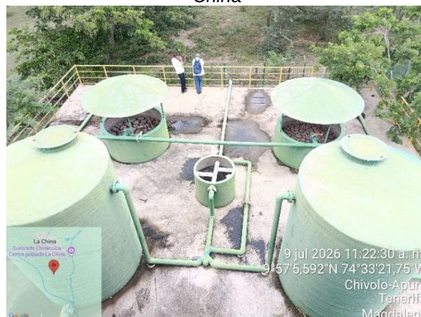
Imagen 46. Planta de Tratamiento de Aguas Residuales - La China
