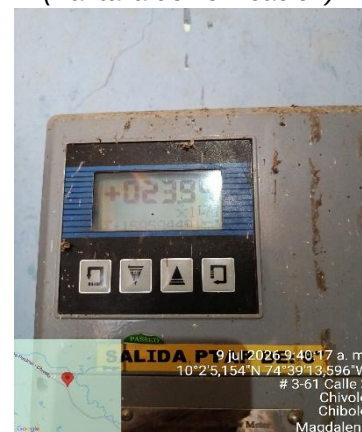
Imagen 20. Macromedidor salida a red en operación. (Pantalla de verificación).
