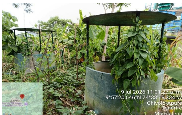
Imagen 30. Lechos de secado fuera de operación.
