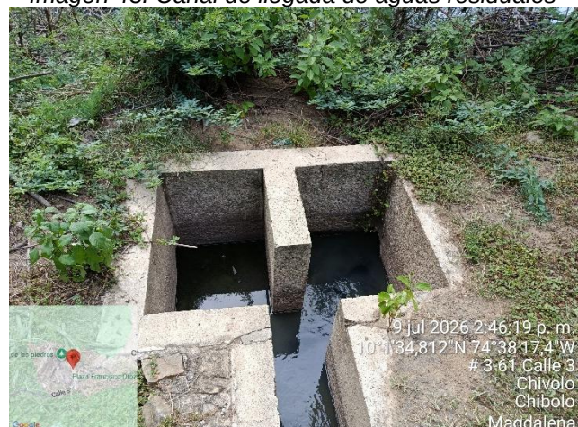
Imagen 43. Canal de llegada de aguas residuales
