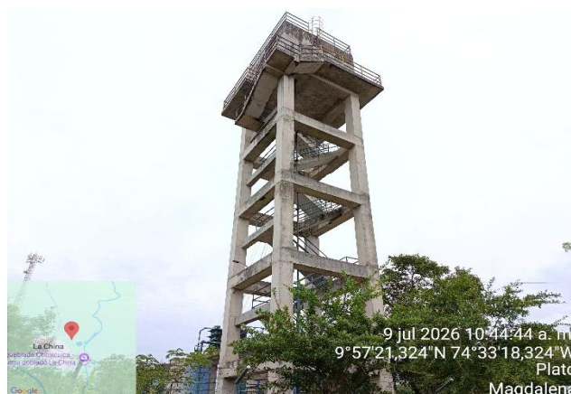
Imagen 29. Tanque aéreo de almacenamiento.
