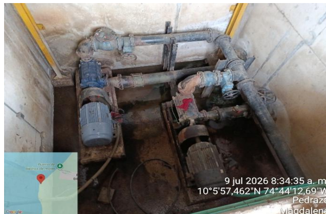
Imagen 7. Electrobombas de impulsión
