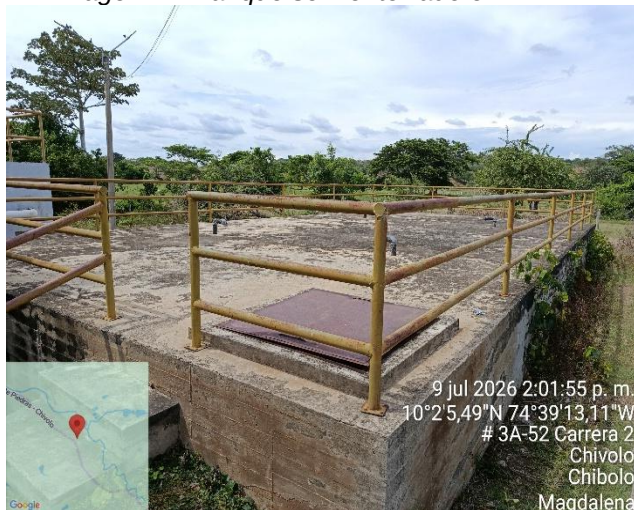
Imagen 21. Tanque semienterrado en PTAP
