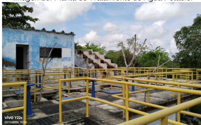
Imagen 10. Planta de Tratamiento de Agua Potable.
