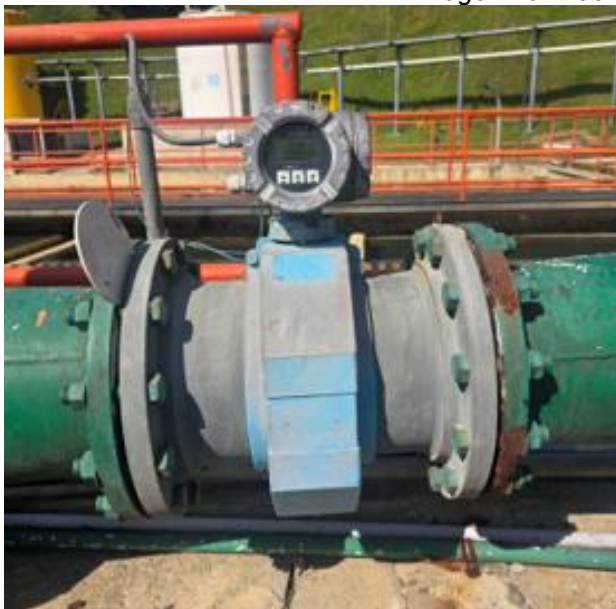
Macromedidor de entrada
