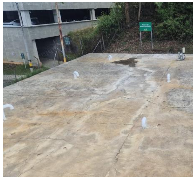
Tanque de contacto de cloro
