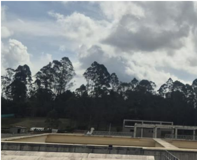
Tanque lodos activados
