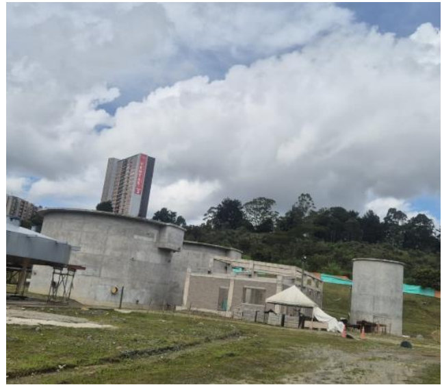
Tratamiento de lodos
