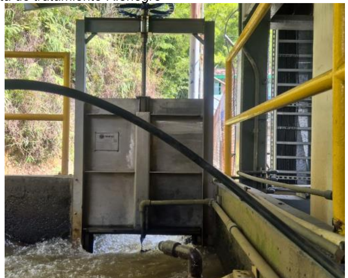
Compuerta módulo 2 y dosificación carbón activado
