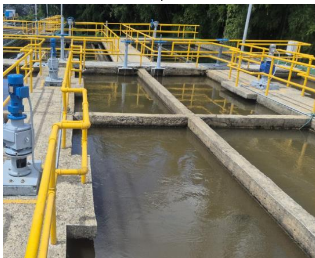
Floculador mecánico módulo 1
