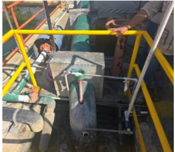
Cámara de Llegada-Dosificación PAC en línea
