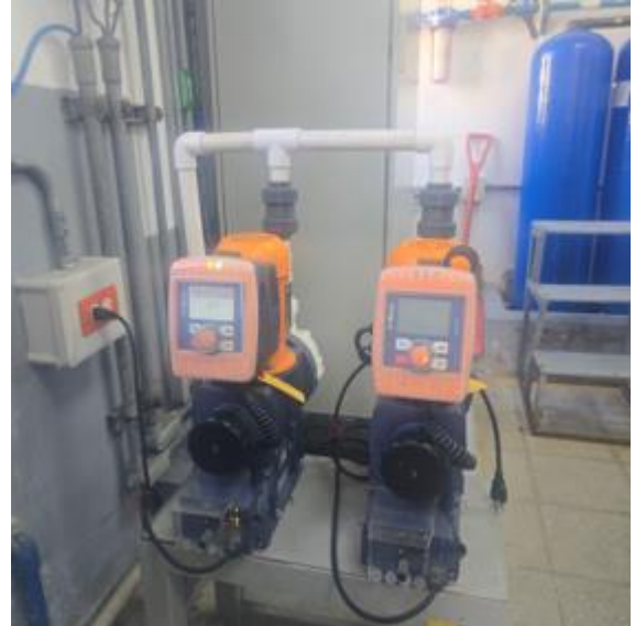
Bombas dosificadoras coagulante
