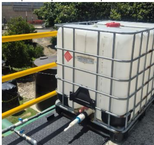
Dosificación final hipoclorito
