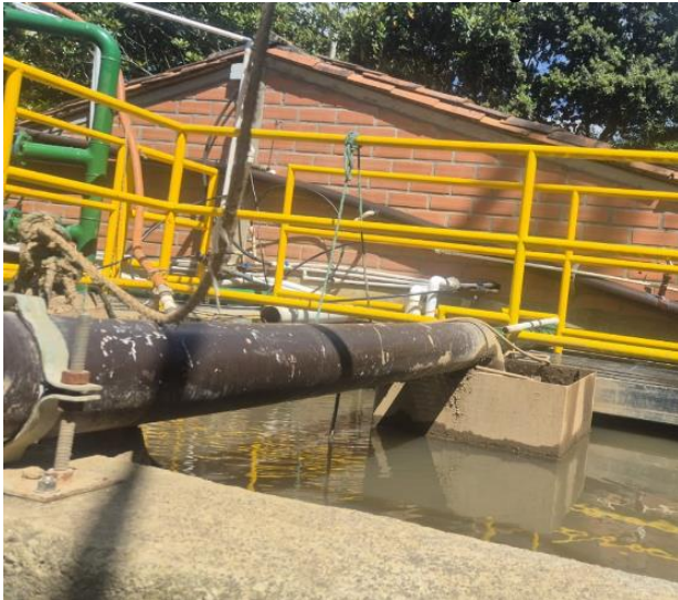
Tanque retorno de lodos
