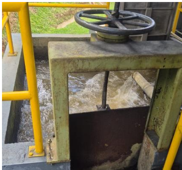
Compuerta modulo 1 desgastada
