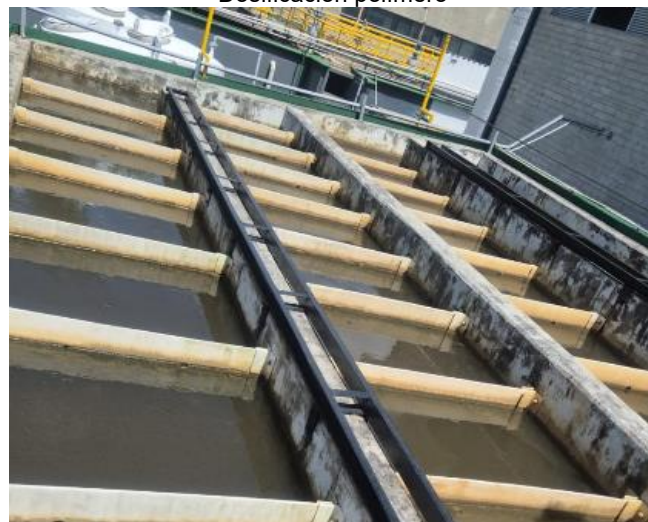
Floculador hidráulico módulo 2
