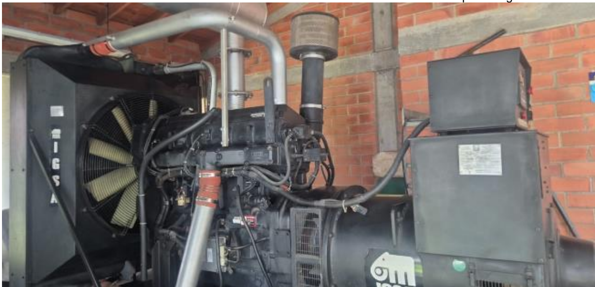
Planta de Emergencia
