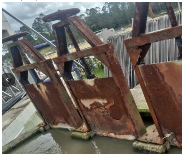
Compuertas de entrada
