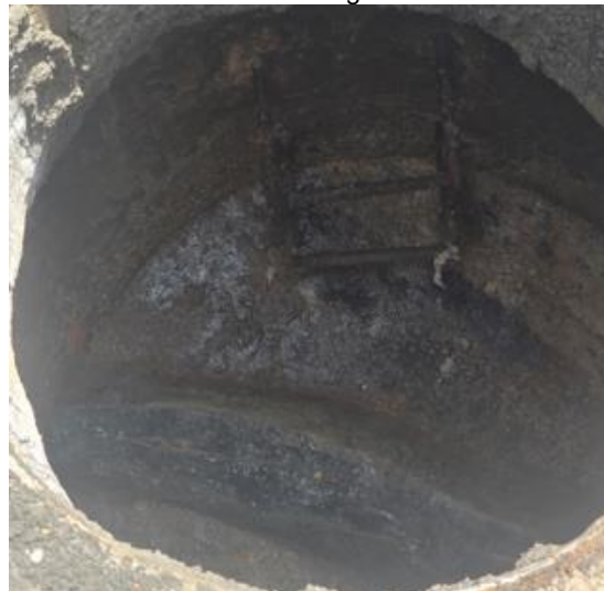
Estado pozo de inspección
