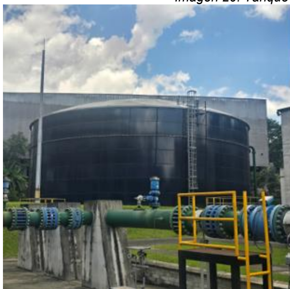
Tanque de almacenamiento Ancón
