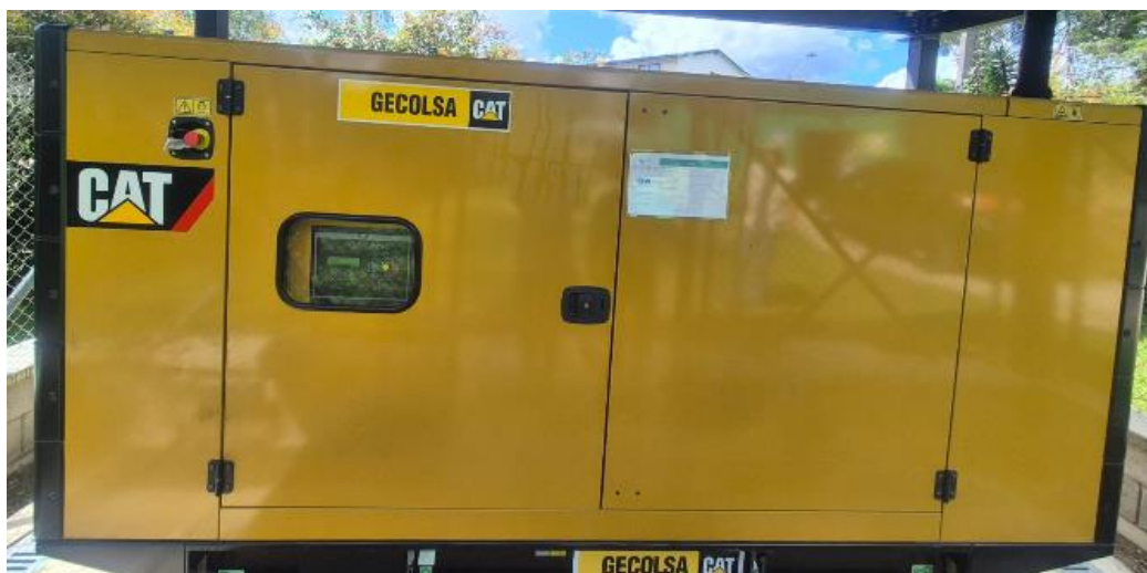
Planta de emergencia
