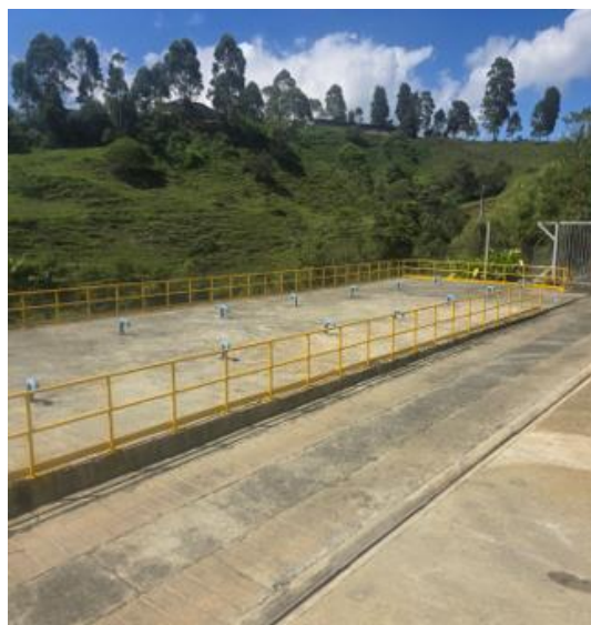
Tanque de almacenamiento de 1.150 m 3
