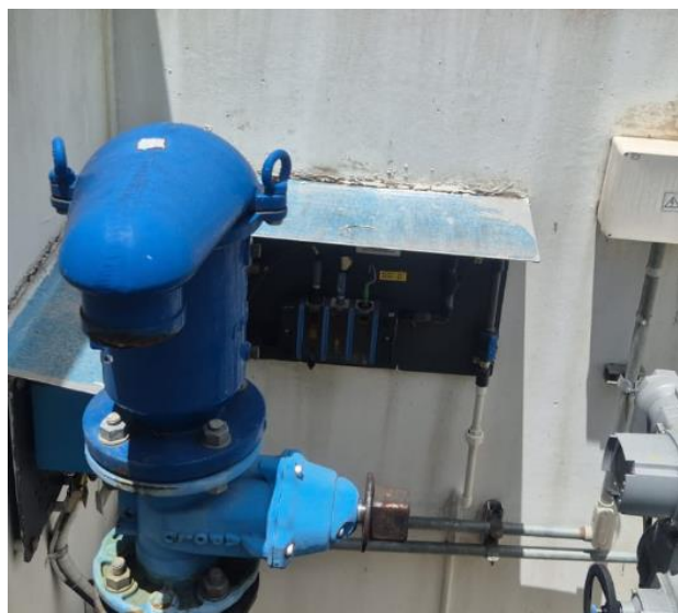
Medidor de pH, Cloro residual y Turbiedad tanque Fontibon
