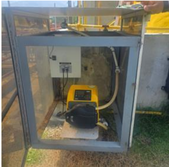
Bomba de dosificación para aplicación de cloro
