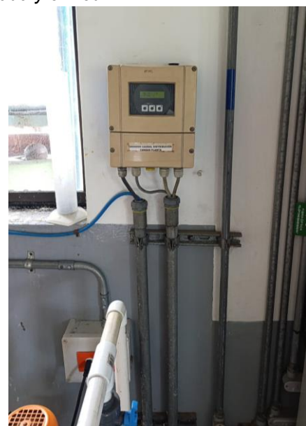
Medidor tanque almacenamiento PTAP Caldas.
