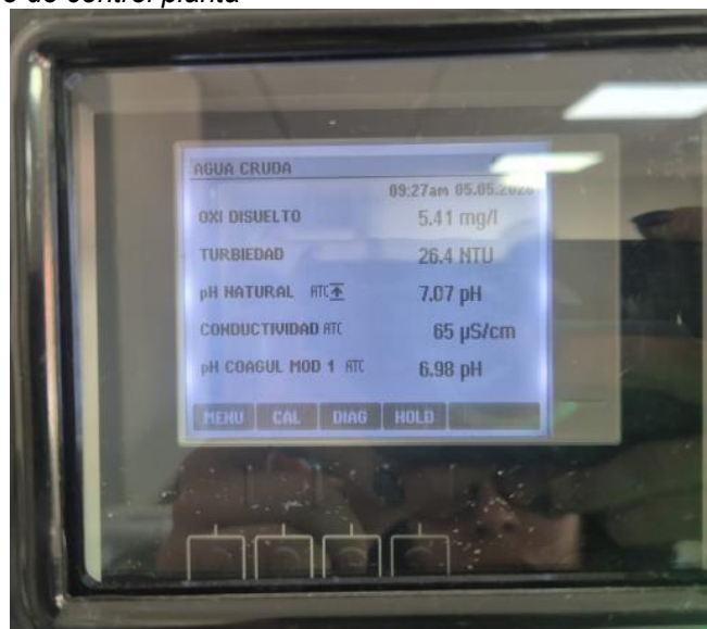
Pantalla de control cuba canal entrada
