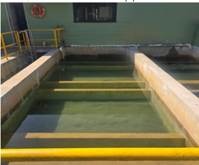
Unidades de filtración
