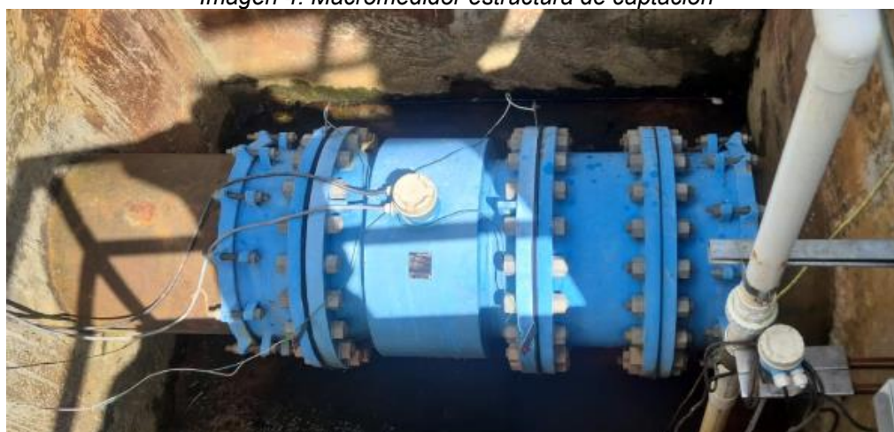
Imagen 4. Macromedidor estructura de captación
