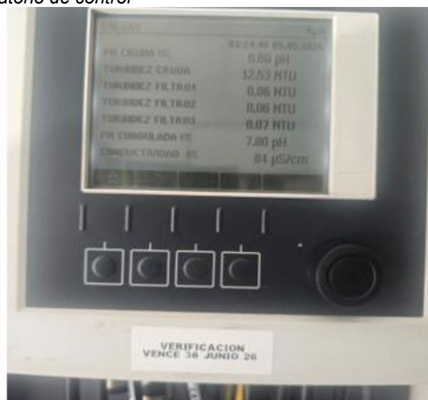
Parámetros medidos mediante sensores para validación
