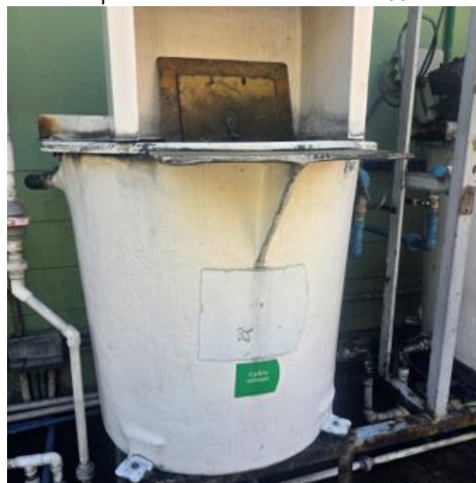
Tanque dosificación Carbón Activado
