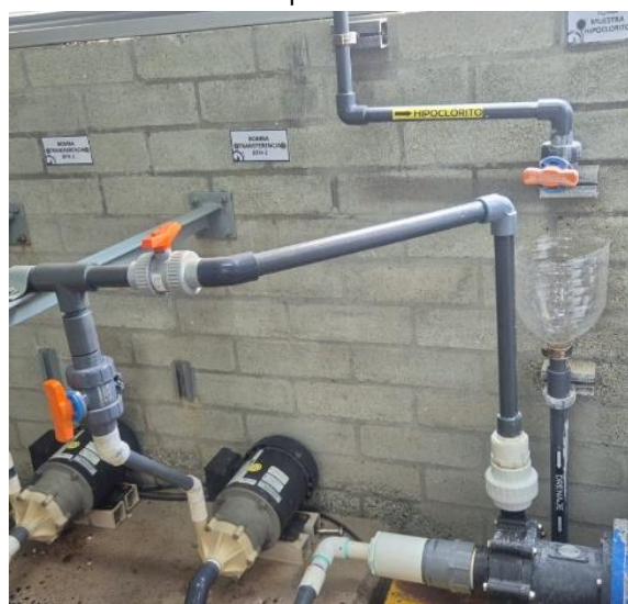
Bombas de transferencia hipoclorito
