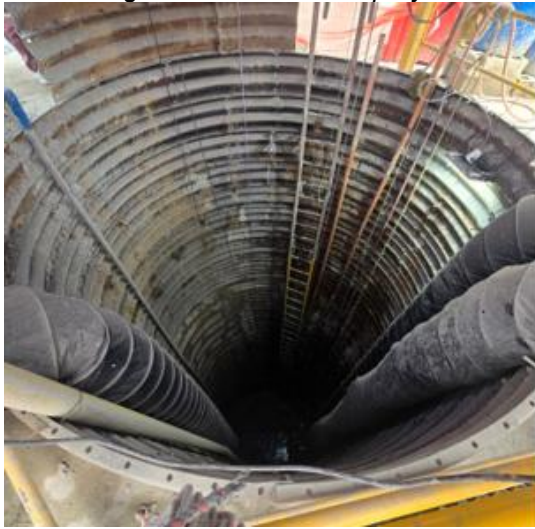
Pozo inspección Colector proyecto Caldas-La Estrella
