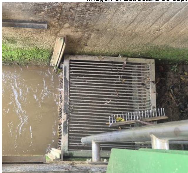
Bocatoma lateral y rejilla
