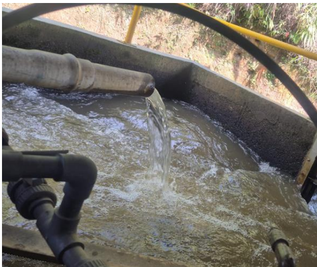
Ingreso agua recirculada cámara de entrada
