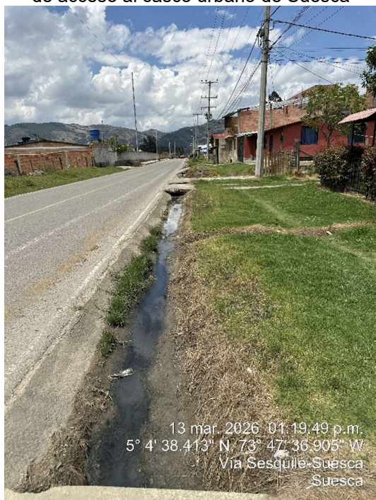
Imagen 2. Descarga de aguas residuales del sector de Buenos Aires sobre la cuneta de la vía de acceso al casco urbano de Suesca
