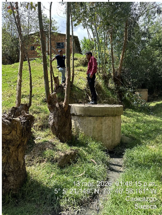
Imagen 13. Cámara de inspección del sistema de alcantarillado de Cacicazgo Alto construida presuntamente por el Municipio de Suesca
