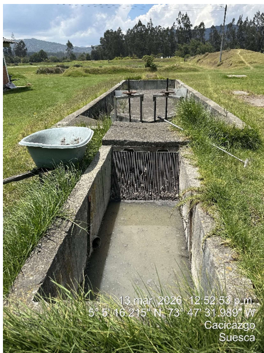
Imagen 5. Canal de cribado de la PTAR municipal
