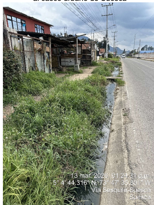
Imagen 3. Descarga de aguas residuales del sector de Buenos Aires sobre la cuneta de la vía de acceso al casco urbano de Suesca
