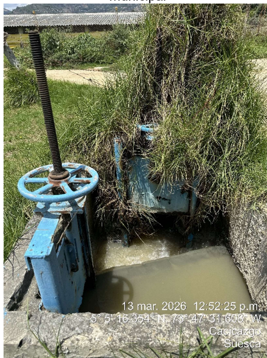
Imagen 4. Cámara de entrada de la PTAR municipal
