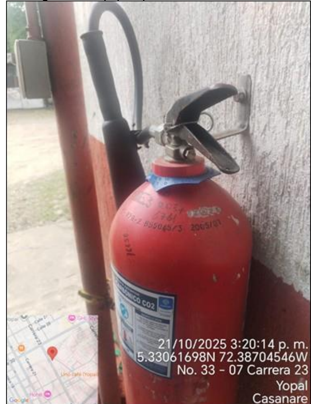
Imagen 37. Equipos para control de incendios
