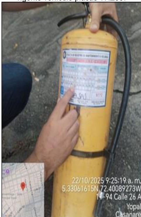
Imagen 42. Inspección extintor con la recarga vigente vehículo placas THZ007
