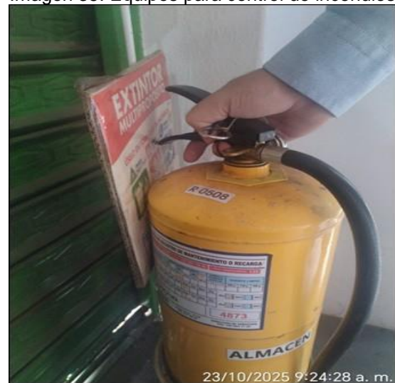
Imagen 35. Equipos para control de incendios
