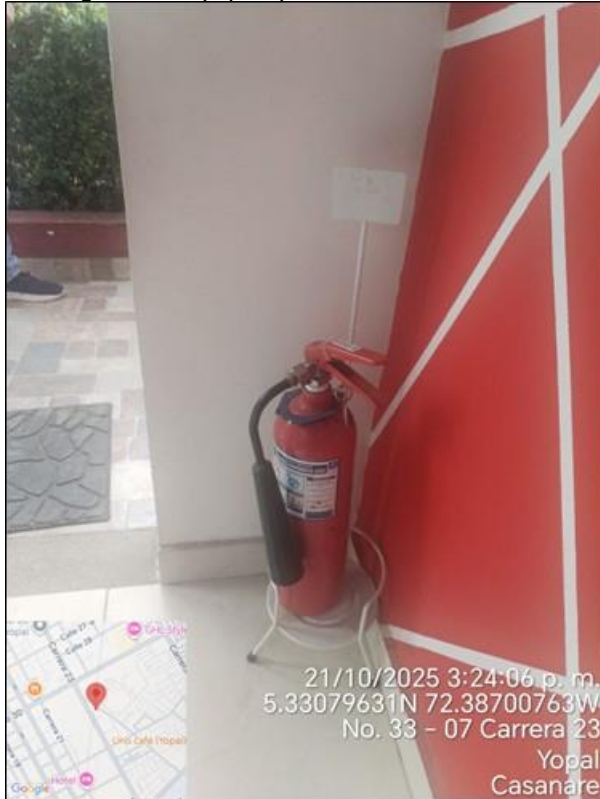
Imagen 36. Equipos para control de incendios
