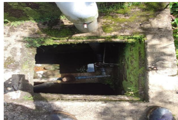
Imagen 24. Tanque sin tapa metálica
