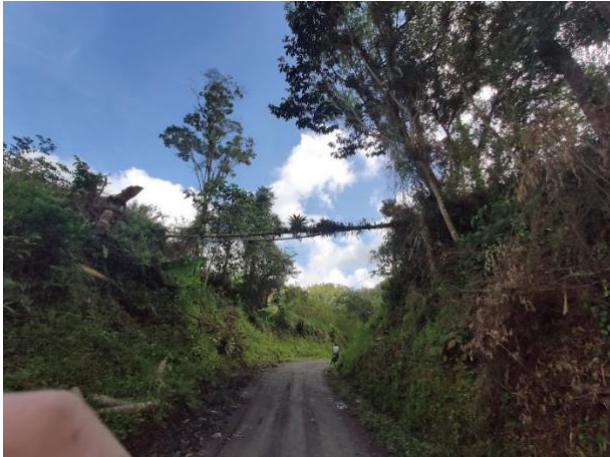
Imagen 7. Paso aéreo línea aducción
