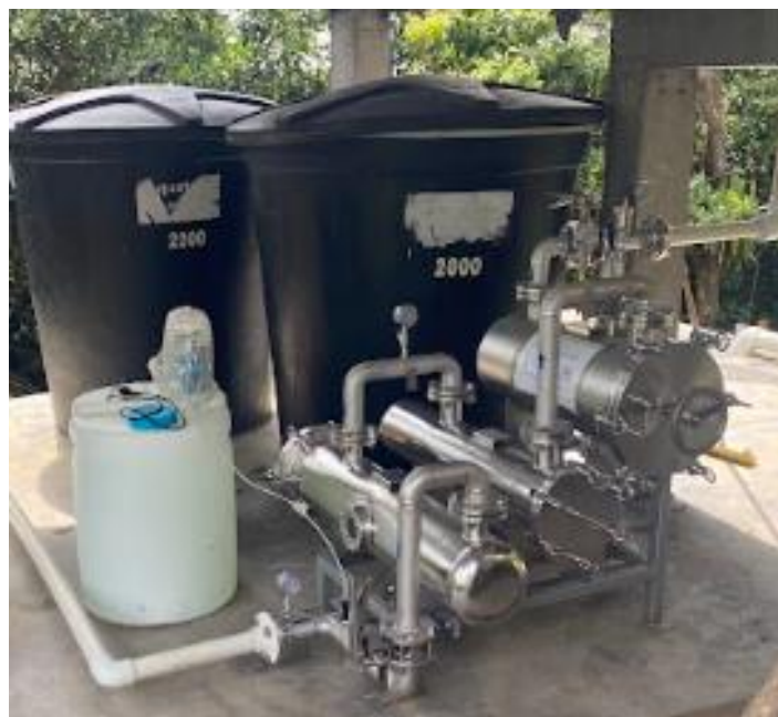
Imagen 3. Sistema filtración y desinfección.
