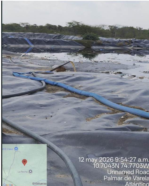
Foto 86 Bombeo de lixiviados
