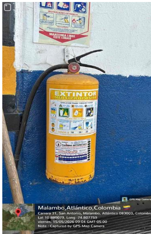
Foto 13. Extintor contra incendios
