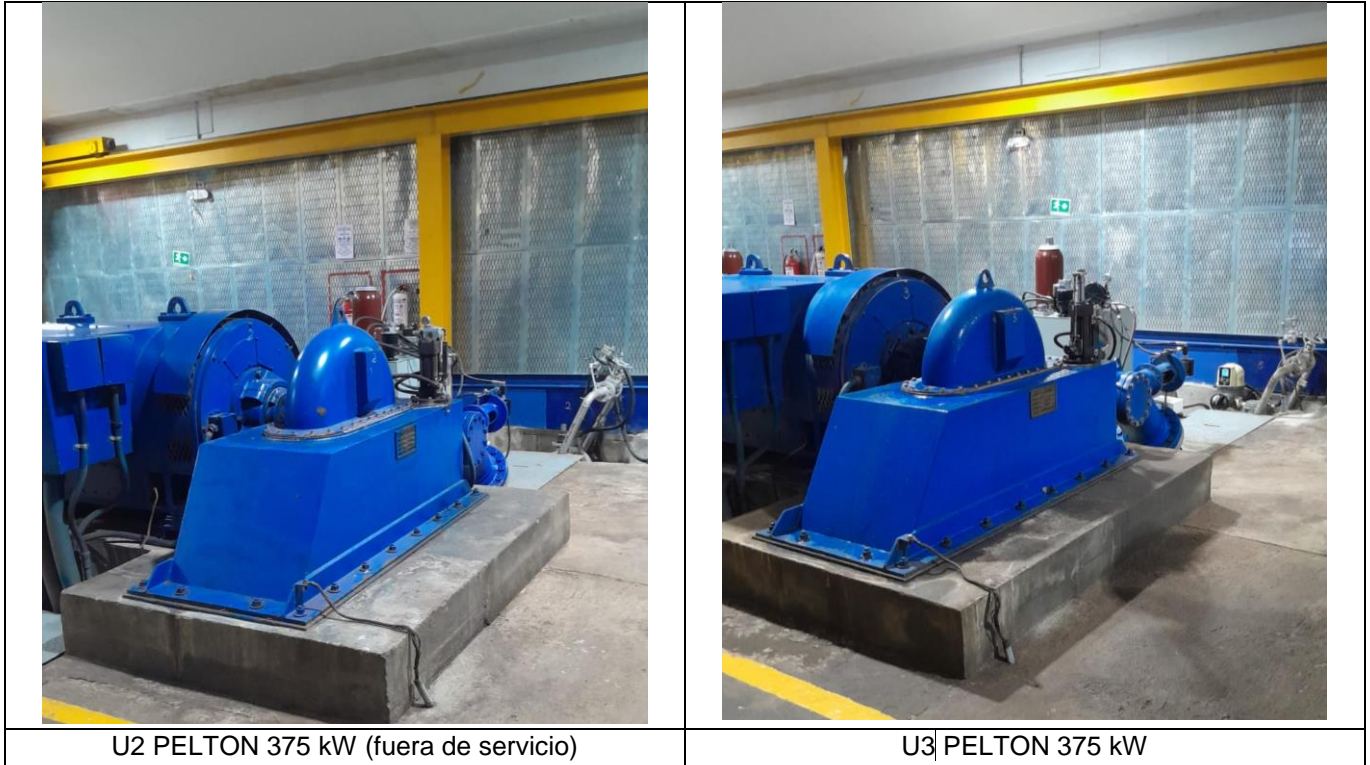
Figura 20. Registro Fotográfico U2 y U3 Central Mutatá – Bahía Solano - GENSA
