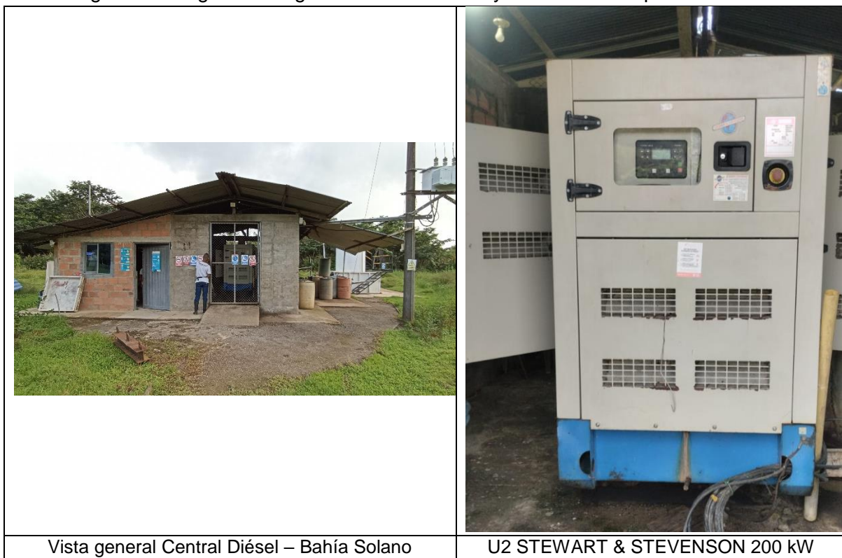
Figura 30. Registro Fotográfico Central diésel y U2 – Bahía Cúpica – GENSA
