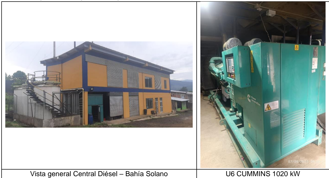
Figura 22. Registro Fotográfico Central diésel y U6 – Bahía Solano – GENSA
