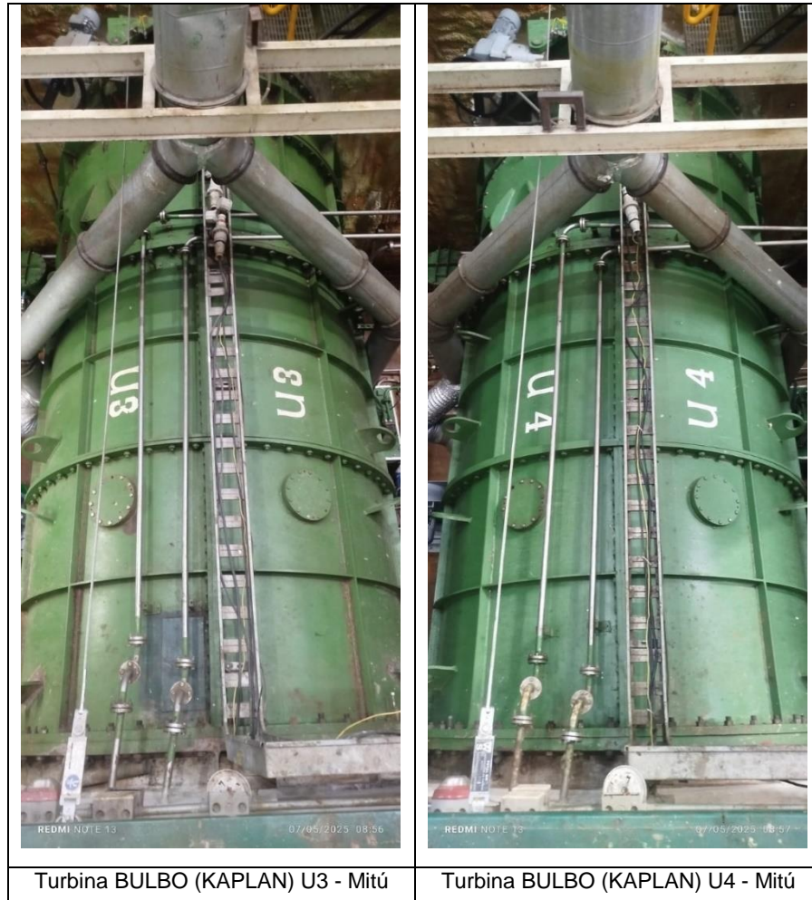
Figura 4. Registro Fotográfico PCH U3 y U4 – Mitú (fuera de servicio) - GENSA
