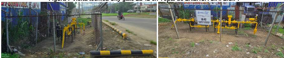
Figura 7 Visita técnica City gate La 42 en Yopal de ENERCA S.A. E.S.P.
