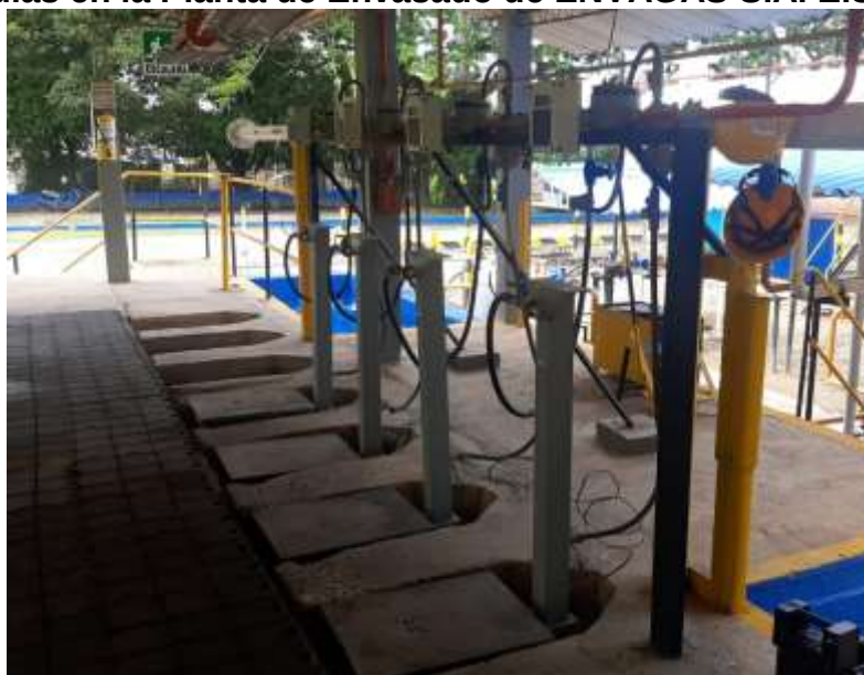
Figura 11: Básculas en la Planta de Envasado de ENVAGAS S.A. E.S.P. Puerto Salgar
