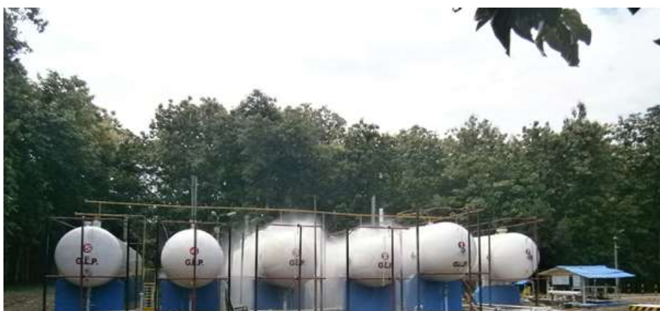
Figura 8: Prueba RCI planta de Almacenamiento de ENVAGAS S.A. E.S.P. en Puerto Salgar
