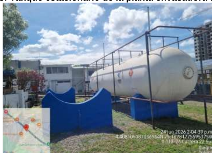
Figura 13: Tanque estacionario de la planta envasadora de Ibagué
