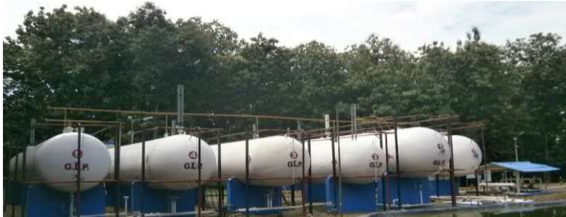
Figura 12: Tanques estacionarios de la planta almacenadora de Puerto Salgar
