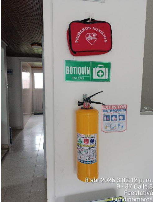
Figura 27. Señalización de elementos
