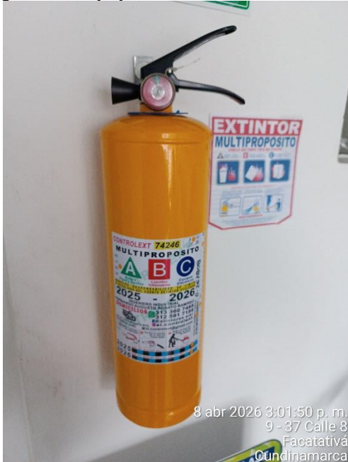
Figura 29. Equipos de control de incendios
