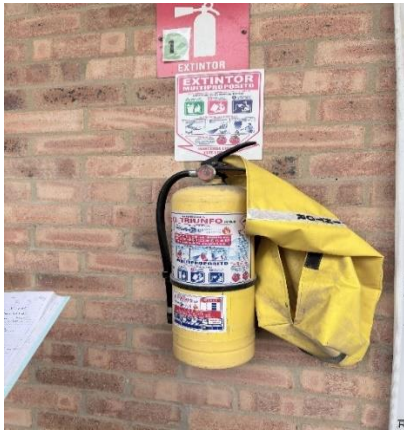
Foto 45 Extintor en zona de recepción de vehículos
