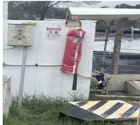
Foto 46 Extintor en zona de tratamiento de lixiviados
