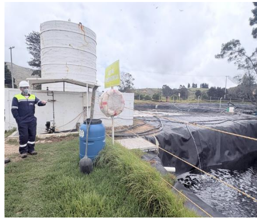
Foto 42. Piscina de almacenamiento de lixiviado tratado
