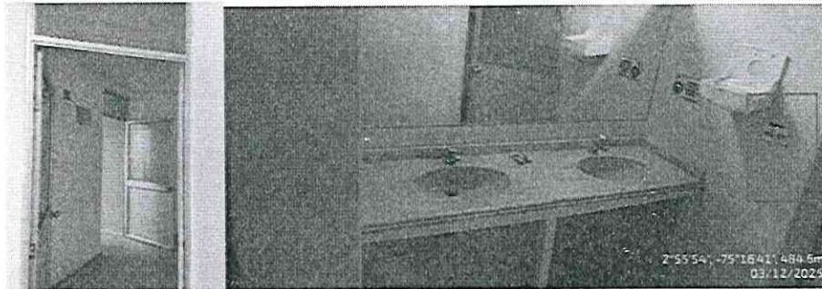
Imagen 02 y 03: Baños área administrativa y condición de riesgo eléctrico.
