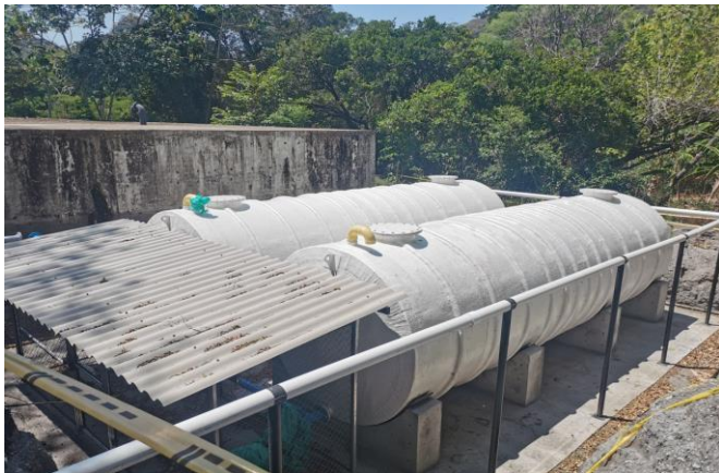
Nuevos tanques de almacenamiento
