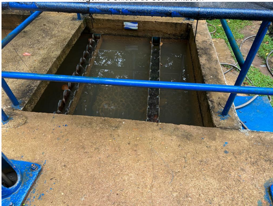
Imagen 18 Unidad de Sedimentación
