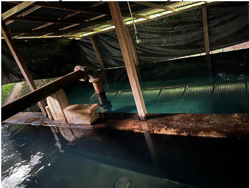
Imagen 25 Tanque de succión de agua potable
