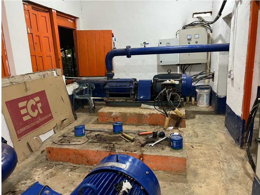
Imagen 26 Estación de bombeo de agua potable
