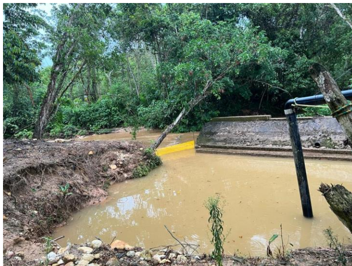
Imagen 1 Quebrada La Culebra - Captación
