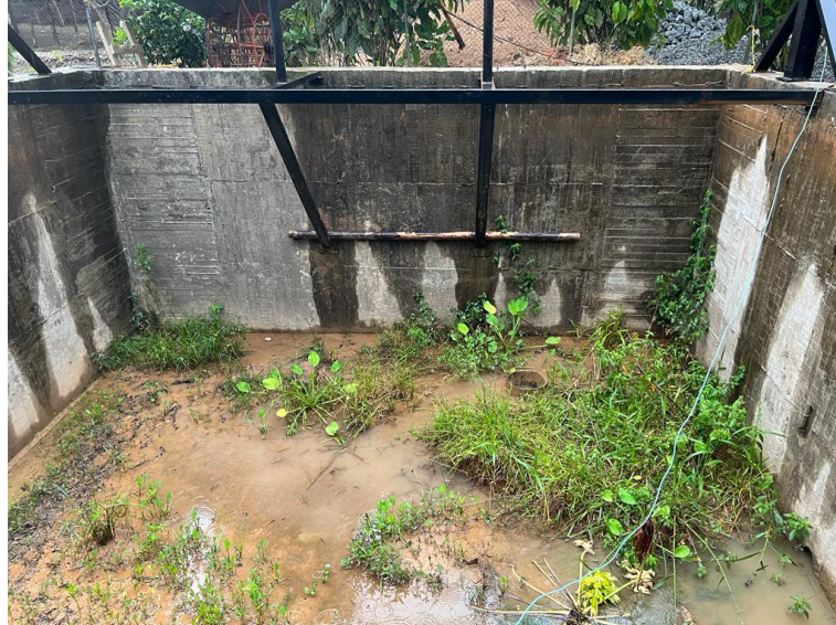
Imagen 5 Tanque de almacenamiento captación La Culebra
