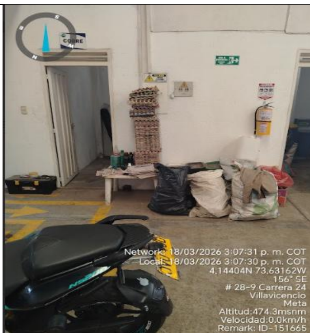
Foto 30. Extintor de incendios multipropósito de 150 libras da de la ECA
