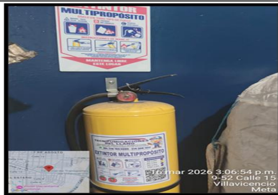
Figura 35. Extintor de incendios No 3 despresurizado ubicado al lado de la entrada de la ECA
