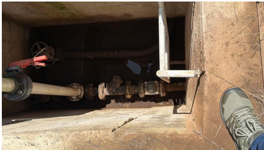
Macromedidor a la salida de la PTAP
