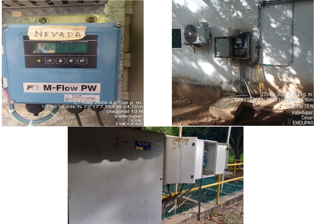
Imagen 10. Macromedidor Distrito Nevada y macromedidores fuera de funcionamiento
