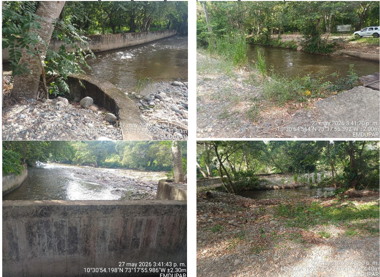
Imagen 5. Registro fotográfico captación de agua río Guatapurí
