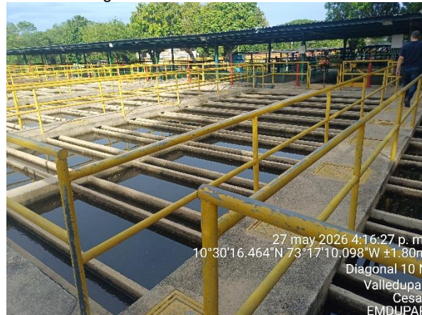
Imagen 8. Estructura de desarenación
