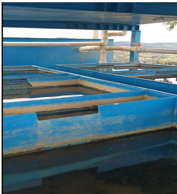
Imagen 19. Módulo de filtración
