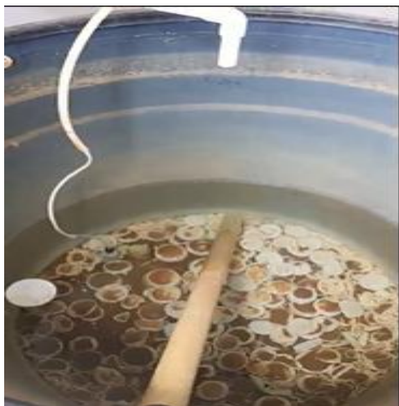
Imagen 21. Tanque de preparación de la solución de cloro para la desinfección
