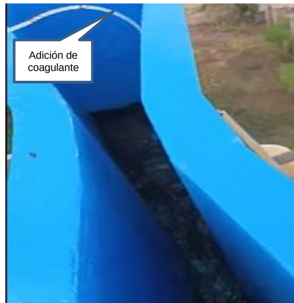
Imagen 16. Preparación y adición de coagulante en mezcla rápida
