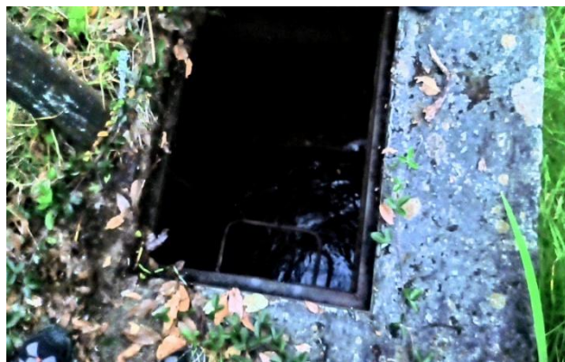
Imagen 8. Cámara de salida del agua captada salida hacia el desarenador
