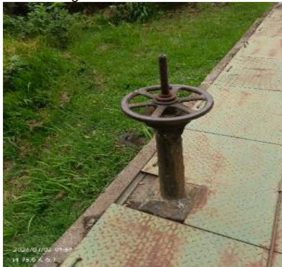
Imagen 11. Válvula de control
