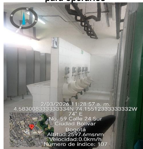
Foto 12 Servicios sanitarios y vestuarios para operarios
