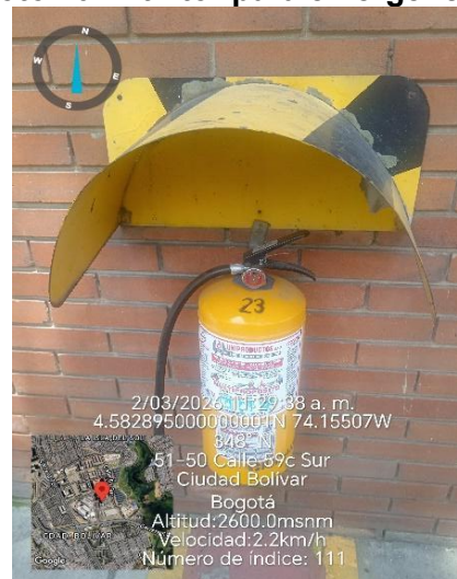
Foto 10 Extintor para emergencias
